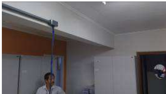
Vazamento na laje identificado próximo ao bocal da calha (secretaria da 5º Vara)
