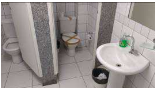
Vaso sanitário do banheiro masculino do prédio anexo com entupimento
