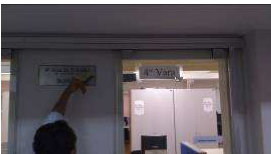
Porta de correr com dificuldade de abertura no 6º andar (4ª Vara)
