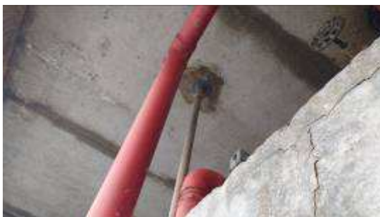
Detalhe de tubulação da caixa d'água com vazamento
