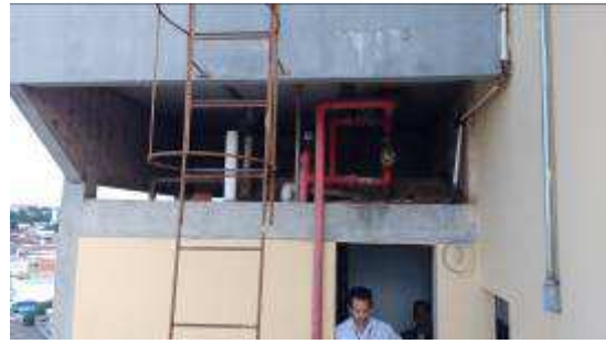
Detalhe de acesso aos registros de manobra da caixa d'água
