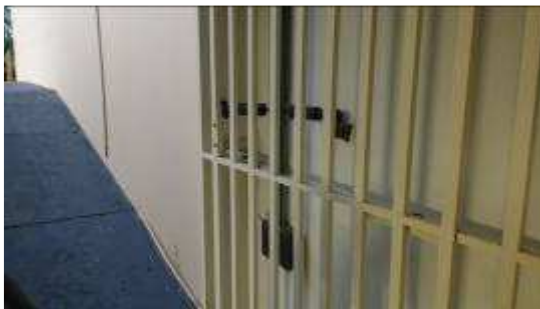
Detalhe de portão de abrir do subsolo com motor apresentado defeito
