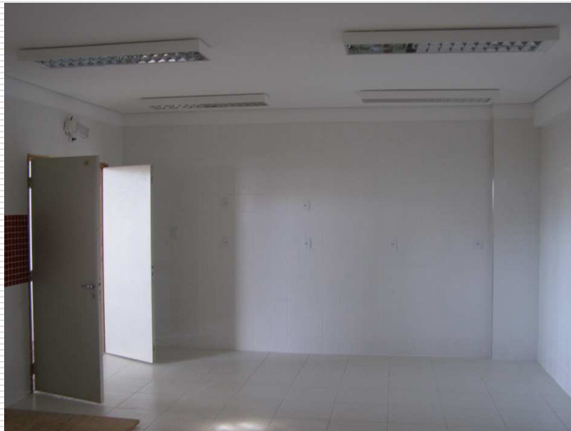
Vista geral do refeitório: (luminárias, inst. elétricas, portas, piso, forro, azulejos instalados)
