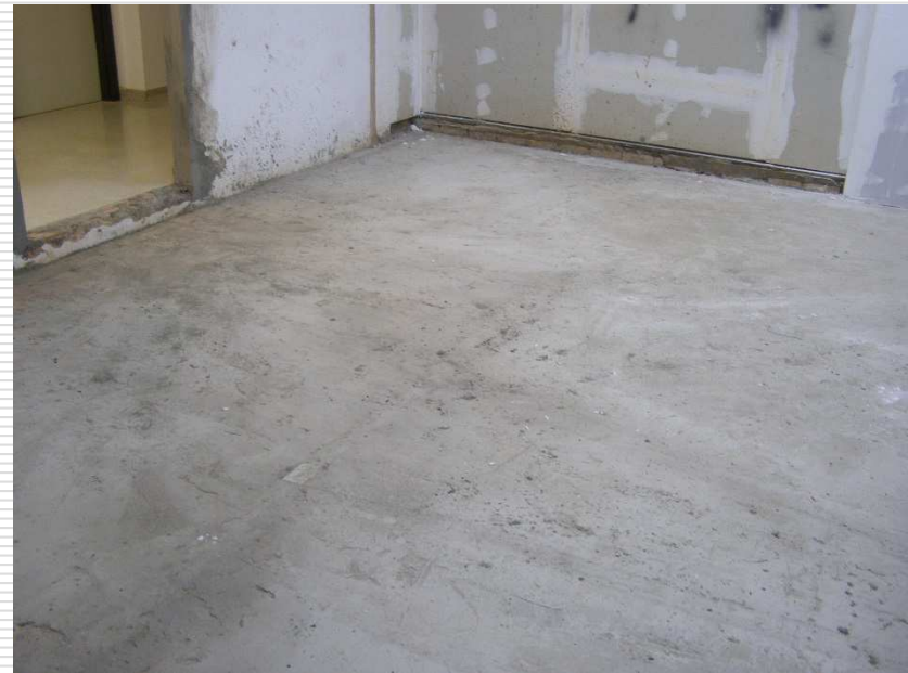
Detalhe do enchimento e regularização da laje para receber o piso elevado
