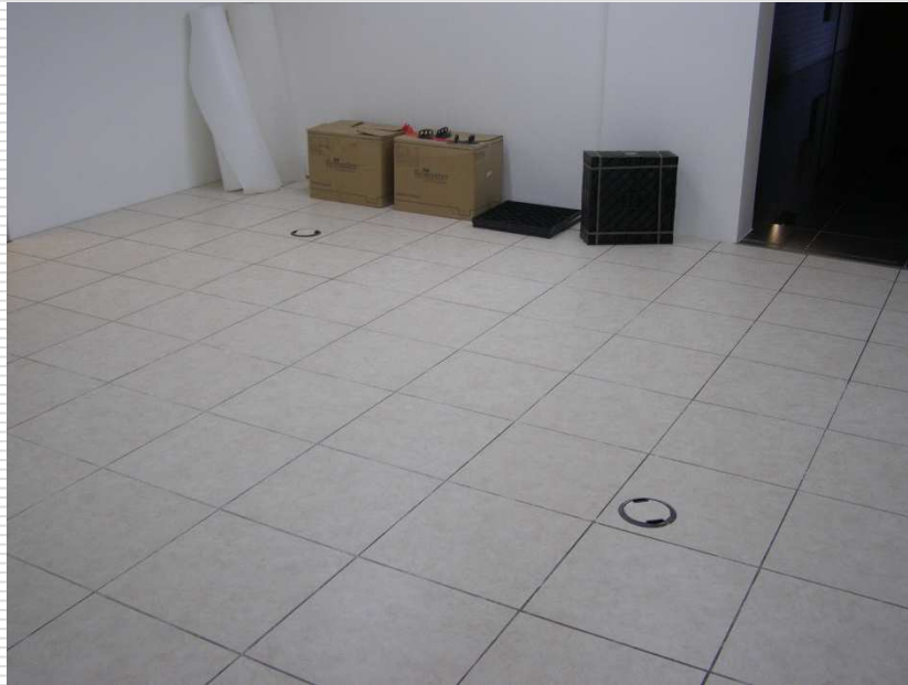
Piso elevado com infraestrutura elétrica
