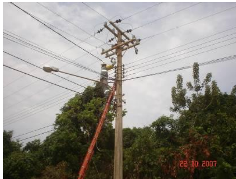
Ligação provisória de energia em baixa tensão
