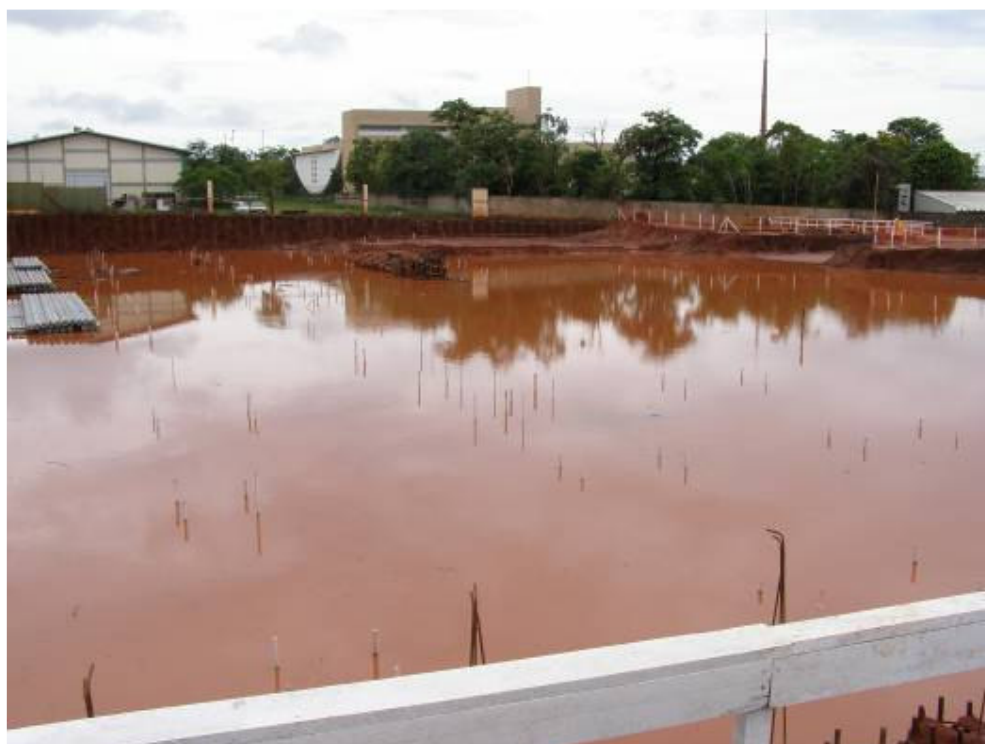
Vista do subsolo após chuva de 150mm na noite anterior
