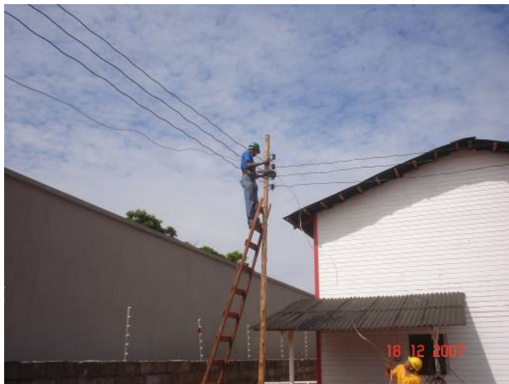
Extensão da rede elétrica interna
