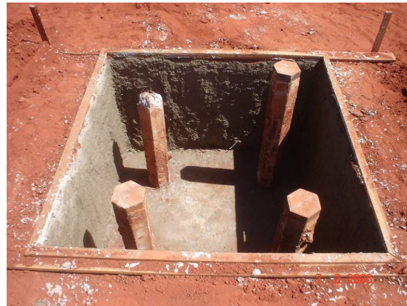
Detalhe do gabarito do bloco de 4 estacas, utilizando o método contra-barranco (sem forma de madeira). já com o lastro de concreto
