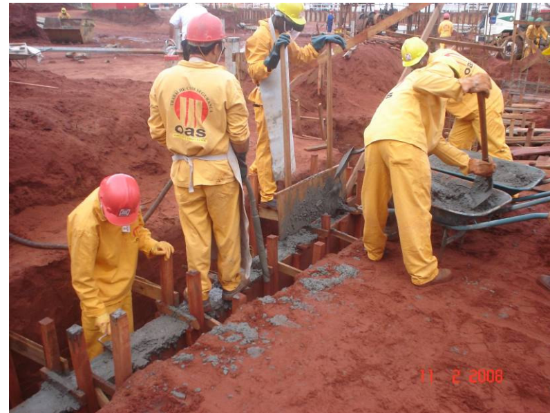
Equipe para concretagem dos baldrame; lançamento manual, vibração do concreto e acabamento (desempenamento com colher de pedreiro).
