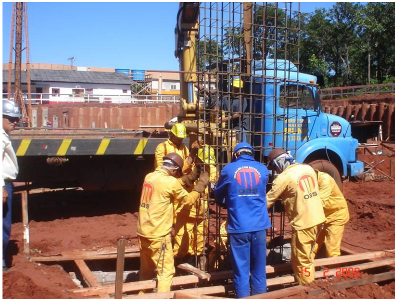
Detalhe da colocação da ferragem de um pilar com auxílio do caminhão munk
