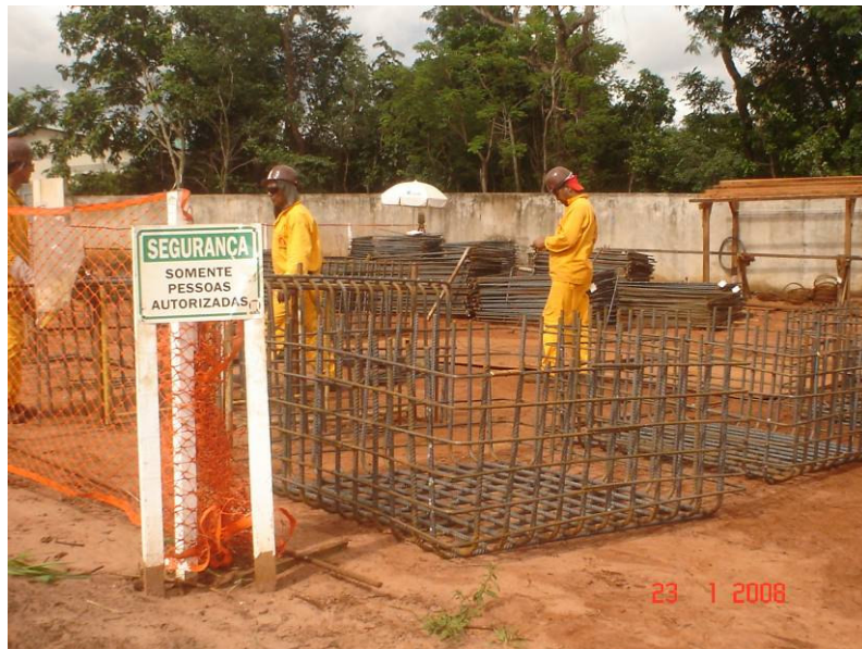
Área reservada para armação das ferragens, detalhe das gaiolas dos blocos de transição
