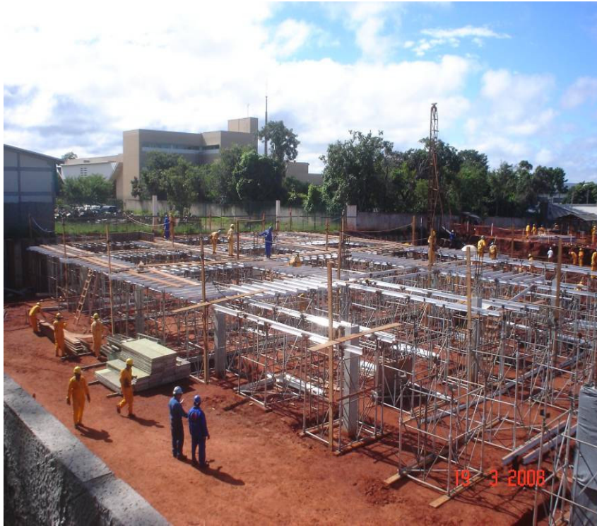
Vista do sistema de cimbramento
