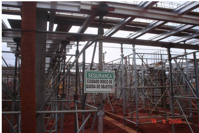
Detalhe da comunicação visual, alertando para o risco de acidentes
