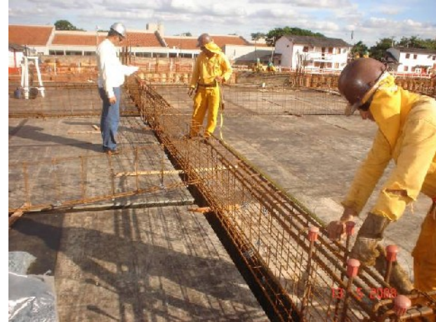
Colocação da armação de viga na 1ª laje da junta B, sendo conferia pelo Eng. De Produção da OAS.
