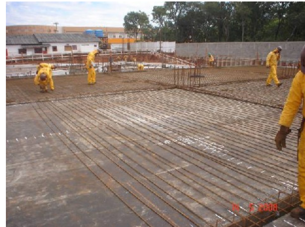
Início da armação da laje da junta B, após revisão de projeto.
