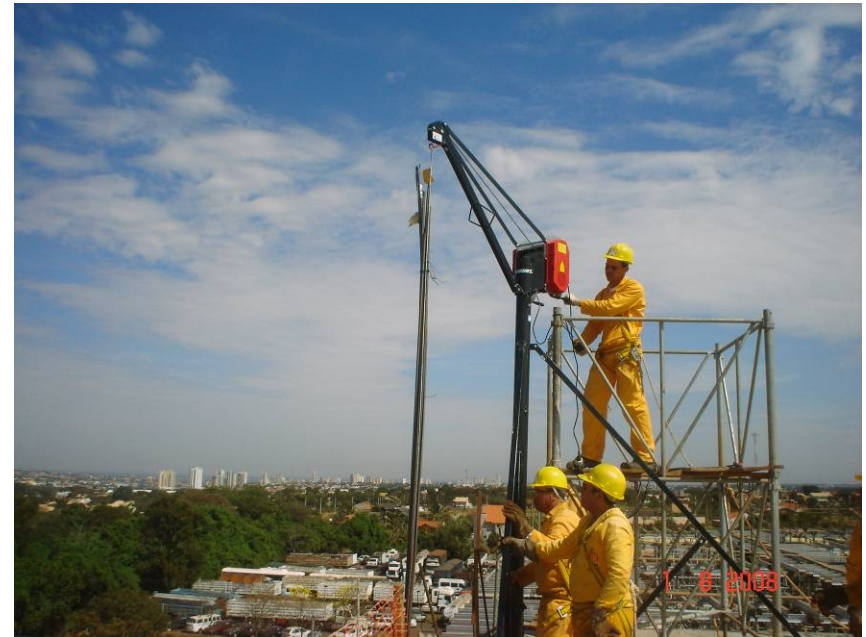
Guincho elétrico utilizado na logística do transporte vertical
