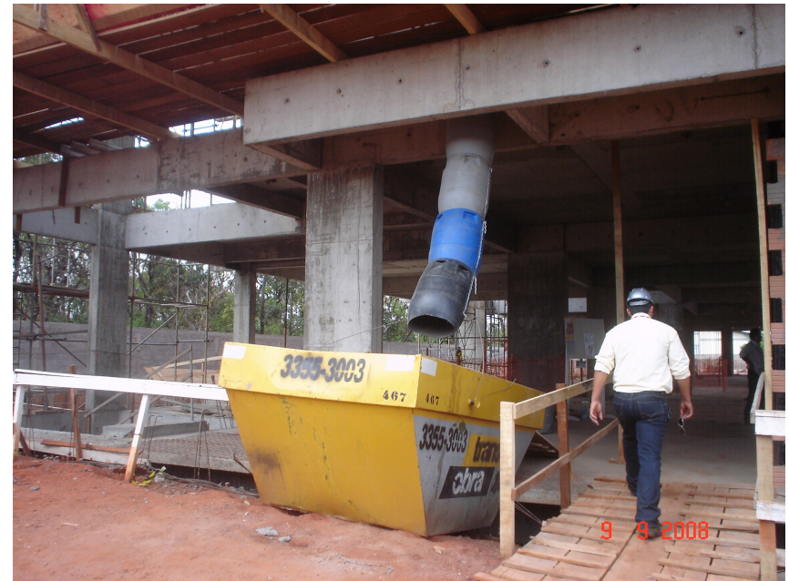
Detalhe do “lixoduto”- Sistema de descarga vertical de entulho
