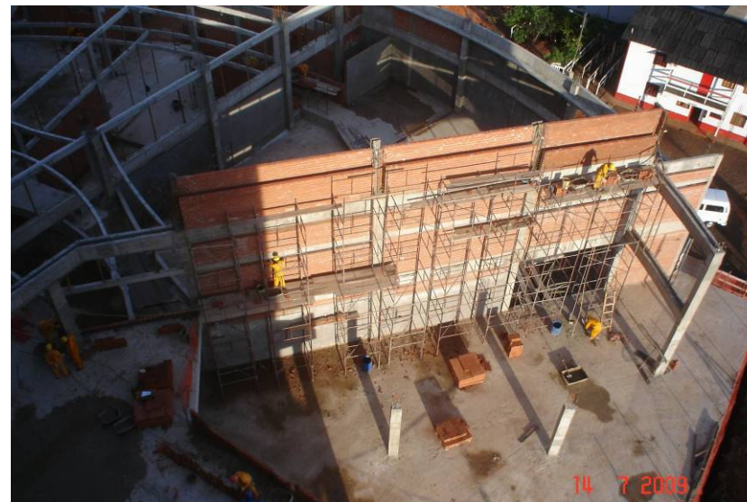
Detalhe da vedação do plenário principal
