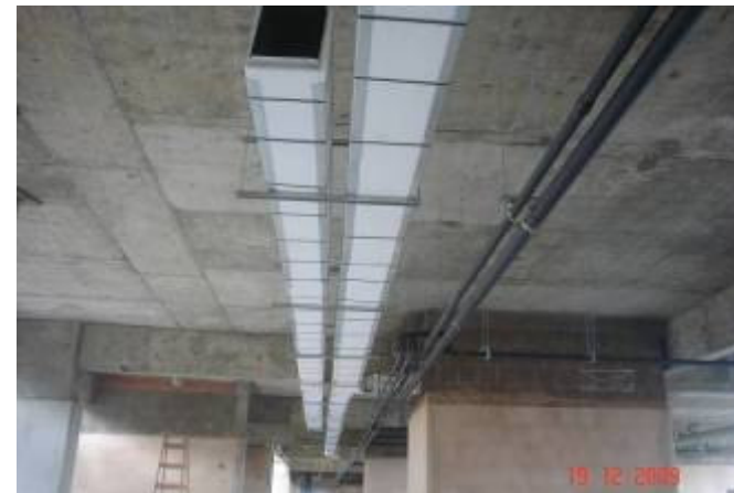
Detalhe de instalação dos dutos de ar condicionado
