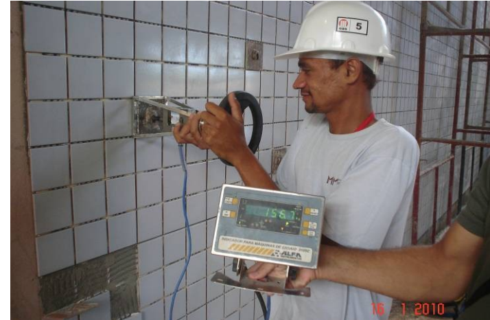
Detalhe do arrancamento do revestimento cerâmico.
