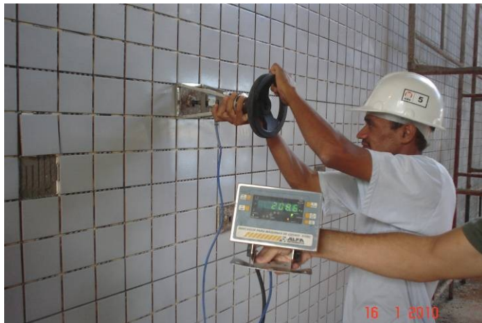
Detalhe do arrancamento do revestimento cerâmico.
