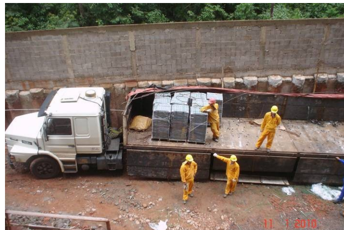
Detalhe da descarga do piso elevado.
