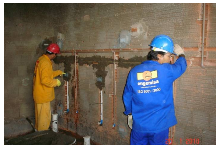
Detalhe da tubulação de água fria para válvula de descarga e ducha higiênica.
