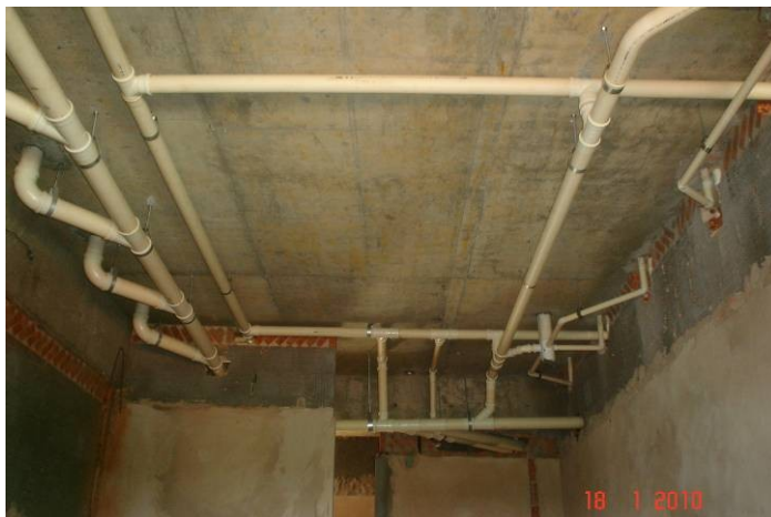
Detalhe da tubulação de esgoto sanitário em banheiros.
