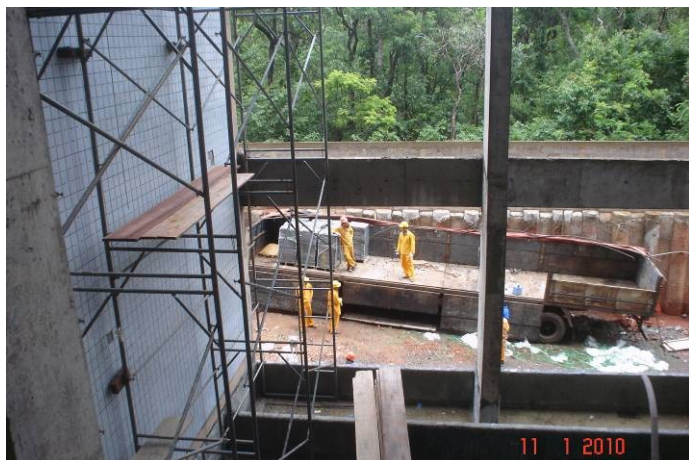
Detalhe da descarga do piso elevado.
