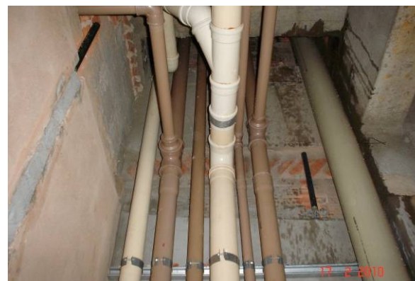
Detalhe das colunas de água fria, prumadas de águas pluviais e tubos de queda de esgoto.
