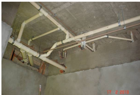
Detalhe do ramal de descarga e ramal de esgoto dos banheiros coletivos.
