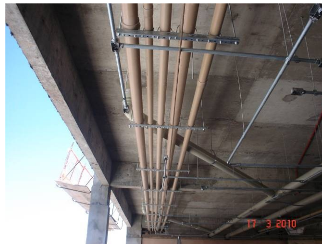
Detalhe da tubulação de Água Fria que interliga o barrilete.
