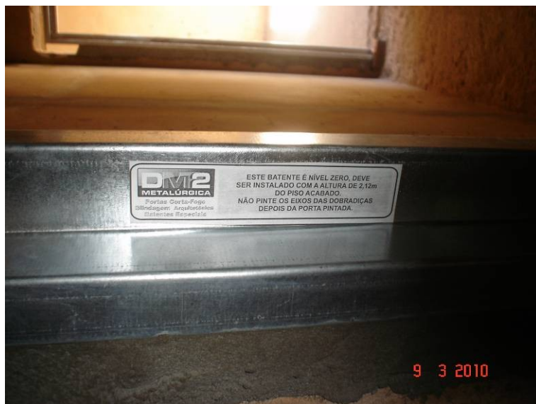
Detalhe de porta corta-fogo depositada no canteiro.
