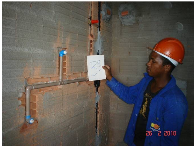
Detalhe da tubulação de Água Fria em copas.
