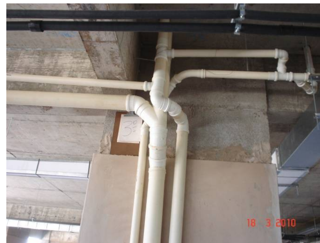
Detalhe da descida da prumada da tubulação de esgoto.
