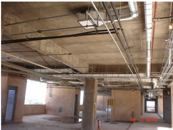
Vista geral das instalações de ar condicionado (3º pavimento).
