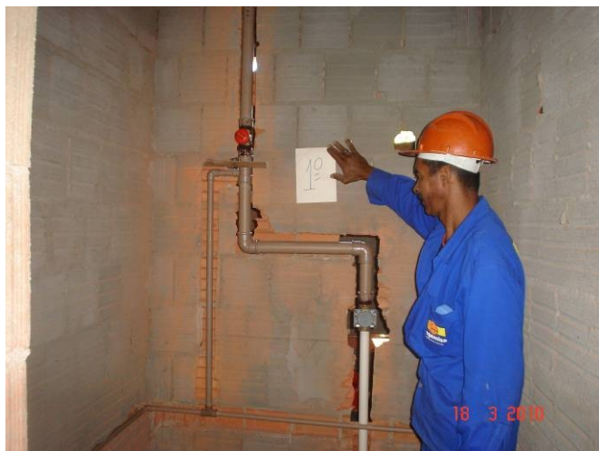
Detalhe da tubulação de Água Fria em banheiros individuais.
