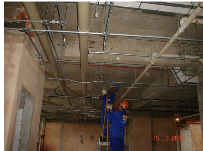
Detalhe de eletroduto para instalações elétricas.
