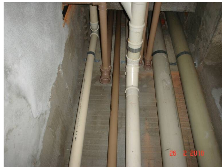
Detalhe da prumada das tubulações de Água Fria, Águas Pluviais e Esgoto Sanitário posicionadas no Shaft.
