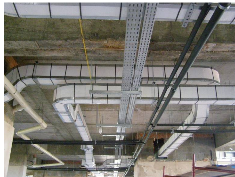
Detalhe da tubulação frigorígena e de exaustão e insuflamento do ar condicionado.
