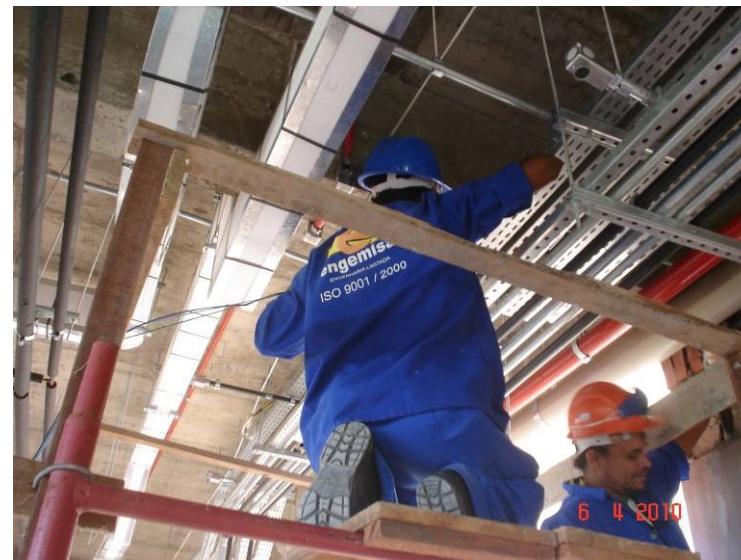
Detalhe da infraestrutura das instalações dos pavimentos.
