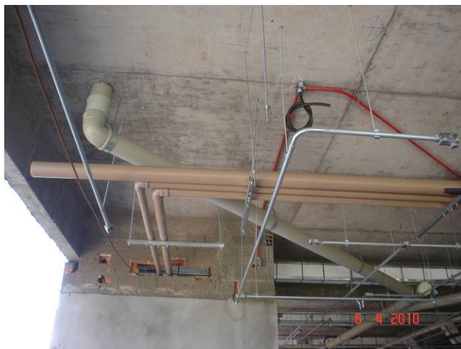
Detalhe da tubulação de água fria de interligação com o barrilete no 2º pavimento.
