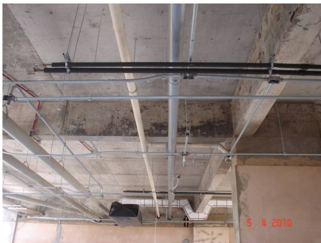
Detalhe da tubulação de instalação elétrica para iluminação.
