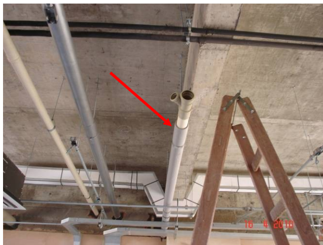
Detalhe de drenagem envelopada com espuma térmica do ar condicionado no 4º pavimento.
