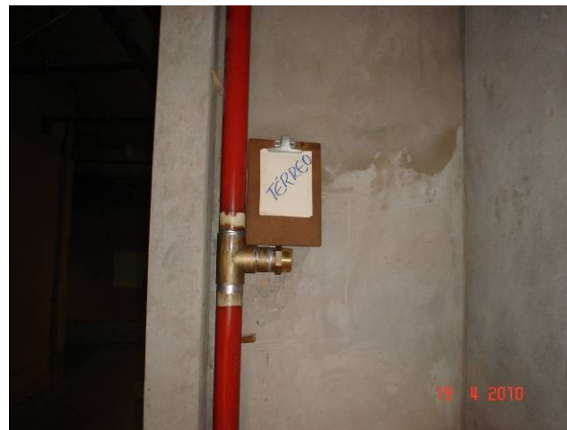
Detalhe da tubulação de hidrante no pavimento térreo.
