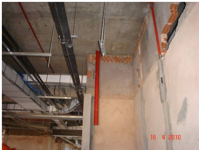
Detalhe de tubulações (vermelha) de alimentação de hidrante e da tubulação de botoeira de alarme.
