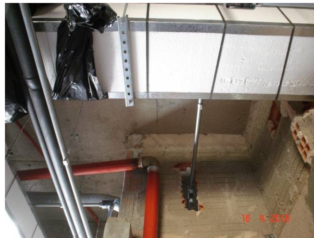
Detalhe da tubulação (vermelha) para alimentação de hidrantes do 4º pavimento.
