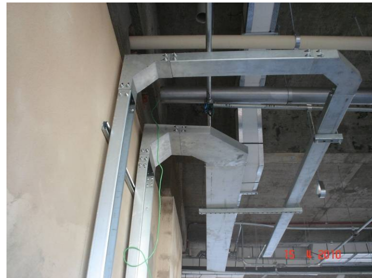
Detalhe das eletrocalhas de instalações de cabeamento estruturado.
