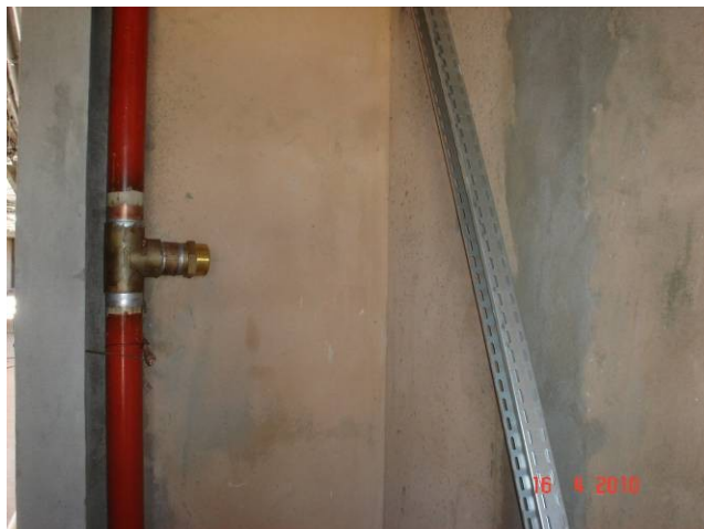
Detalhe da tubulação de hidrante no 3º pavimento.
