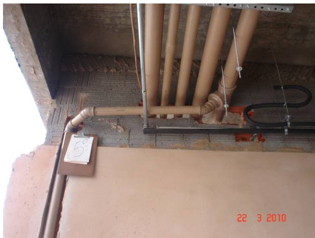
Detalhe da tubulação de interligação do barrilete com a prumada de Água Fria do 5º pavimento.
