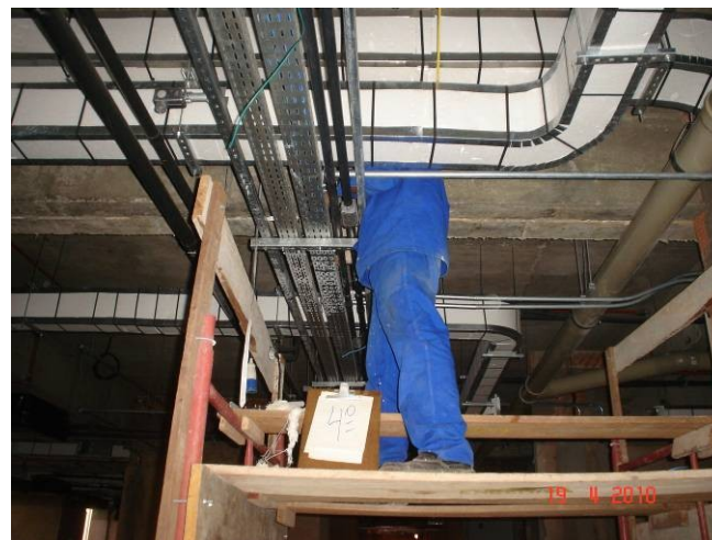
Detalhe das eletrocalhas para passagem de fiação no 4º pavimento.
