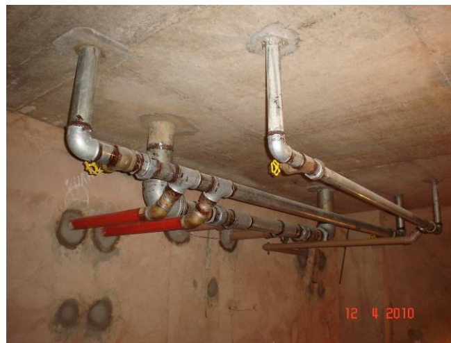
Detalhe da tubulação do barrilete na saída do reservatório elevado na cobertura
