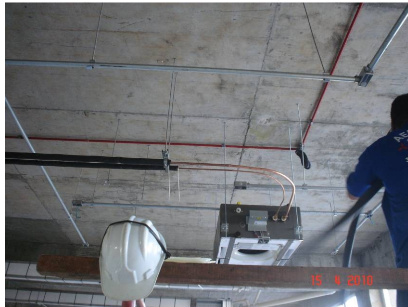
Detalhe das unidades evaporadoras do ar condicionado.
