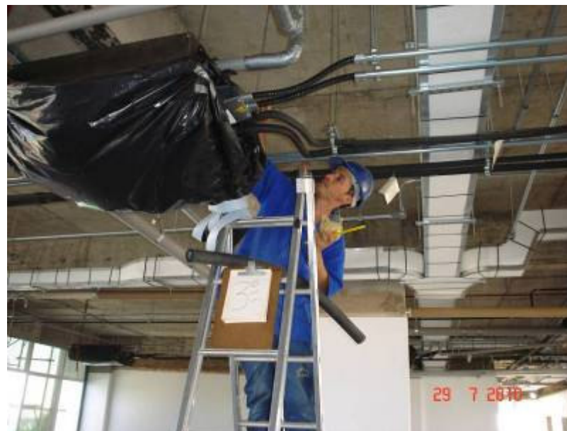
Detalhe da interligação do dreno de climatização, instalação elétrica e tubulação frigorígena nas unidades evaporadoras do 3º pavimento.
