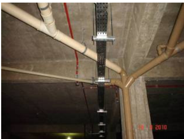
Vista da tubulação (vermelha) para passagem de fiação dos detectores de fumaça no subsolo.
