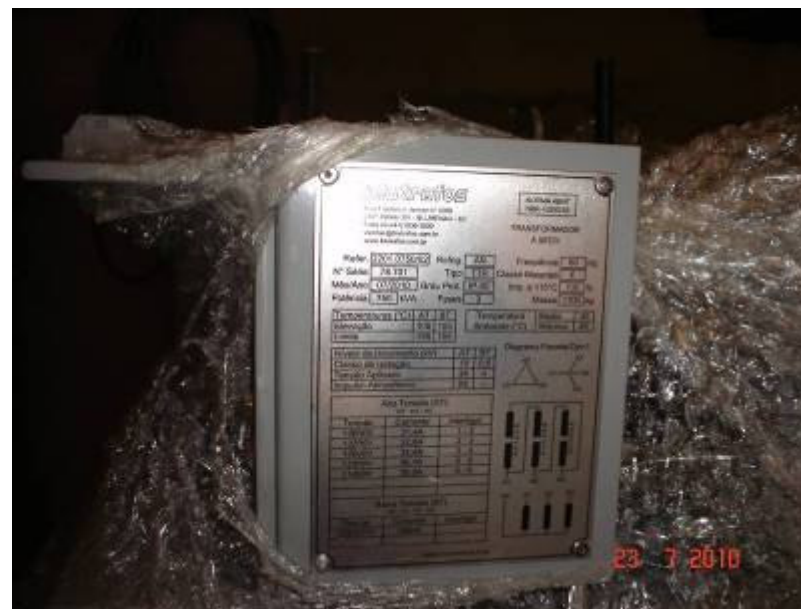
Detalhe do transformador da subestação do subsolo.
