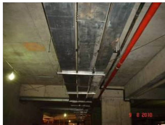
Vista das eletrocalhas para passagem de fiação no subsolo.
