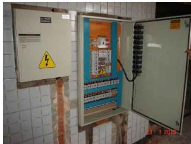
Detalhe dos quadros de energia elétrica dos pavimentos.
