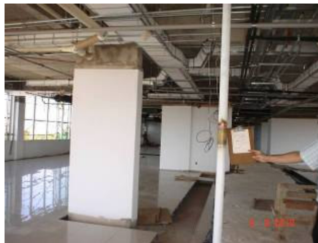
Detalhe da tubulação de hidrante no 3º pavimento.
