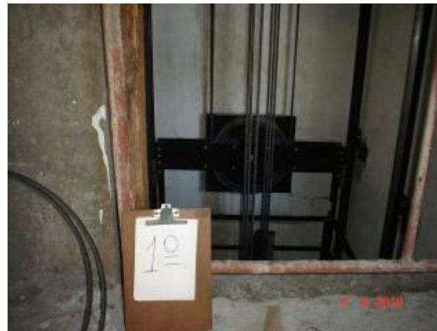
Detalhe dos cabos dos elevadores instalados no 1º pavimento.
