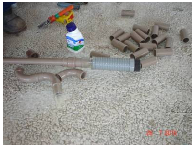
Detalhe das conexões para ligação do dreno de climatização às unidades evaporadoras.
