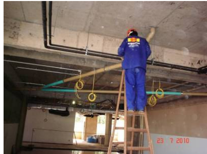
Detalhe da tubulação de águas pluviais (azul) no pavimento térreo.
