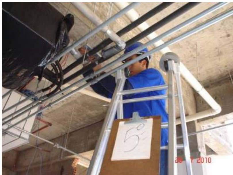
Detalhe da interligação dos drenos de climatização nas unidades evaporadora do sistema de ar condicionado.
