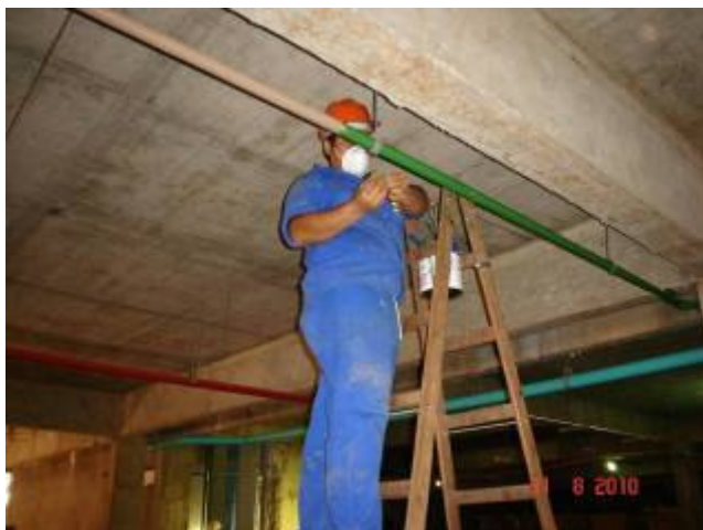
Detalhe da pintura de identificação de tubulação
