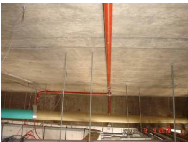
Detalhe da tubulação de hidrante interno nos pavimentos
