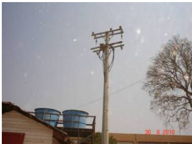
Vista do poste de entrada de média tensão, no interior do terreno, para alimentação da rede pública
