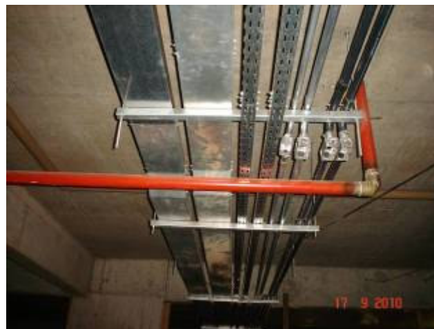
Detalhe da tubulação de hidrante interno nos pavimentos (subsolo)
