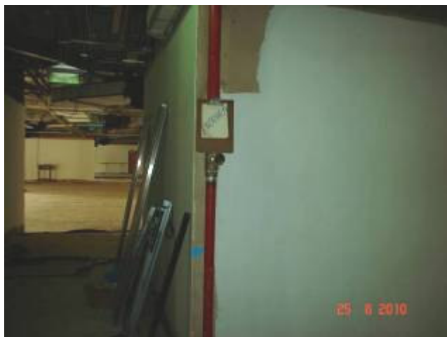
Detalhe da tubulação de hidrante interno nos pavimentos (térreo)
