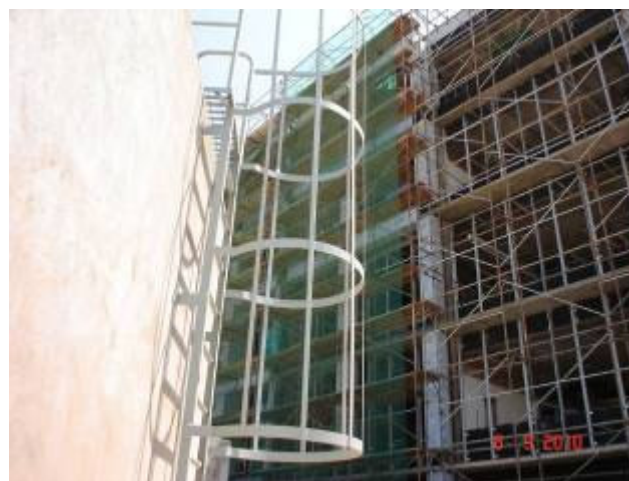
Detalhe de escada tipo marinheiro instalada na parte externa
