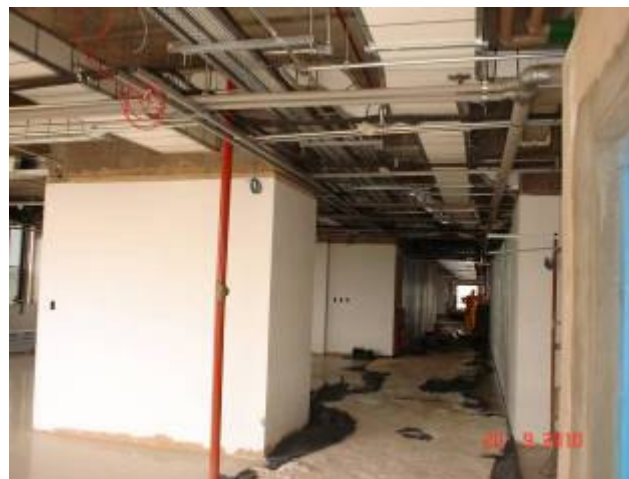
Detalhe da tubulação de hidrante interno nos pavimentos
