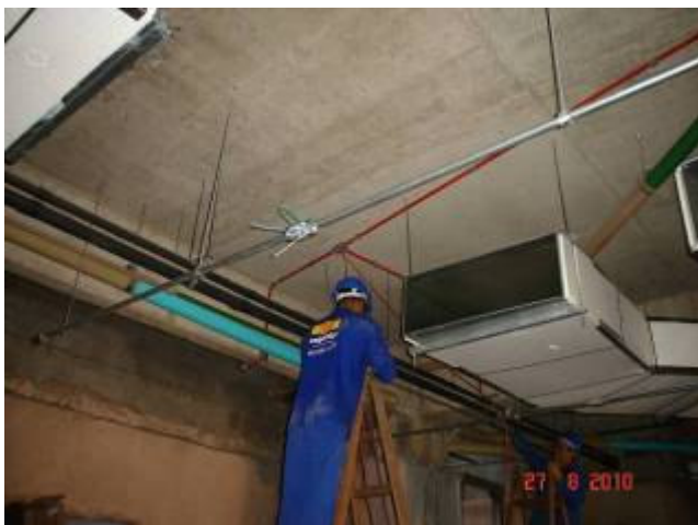
Detalhe de dutos de exaustão e insuflamento nos pavimentos
