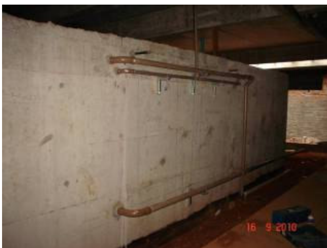
Vista da tubulação de saída do reservatório de água fria do subsolo
