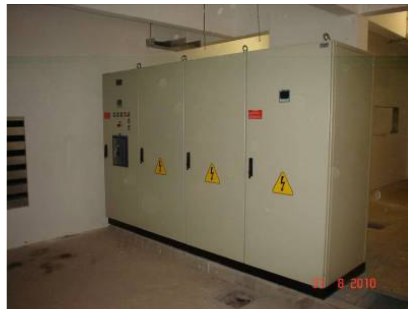
Conjunto de Quadro Geral de Baixa Tensão (QGBT) da subestação do subsolo
