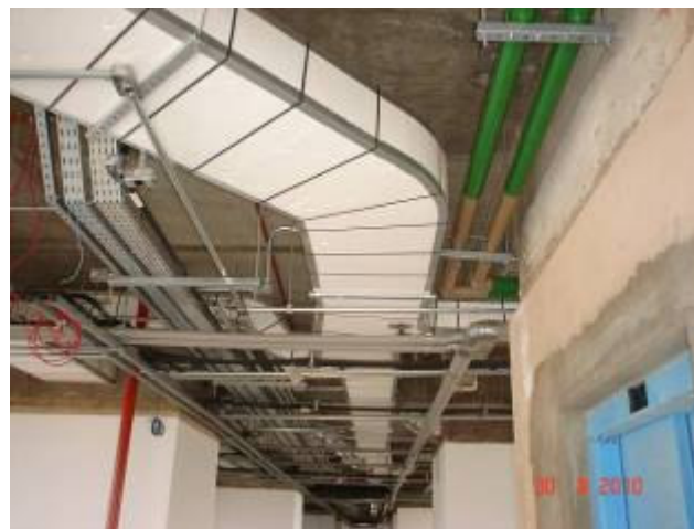
Detalhe de dutos de exaustão e insuflamento nos pavimentos
