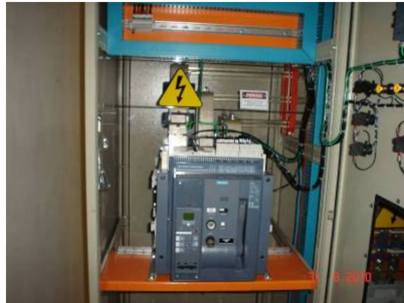
Disjuntor Geral do Quadro Geral de Baixa Tensão da subestação do subsolo
