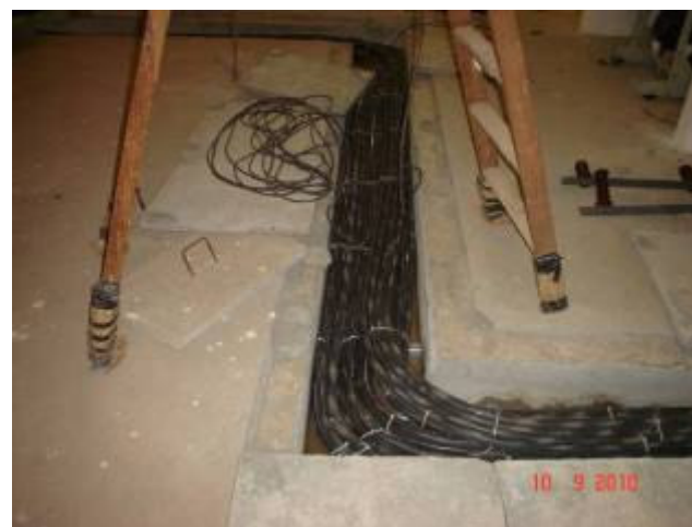
Detalhe da fiação de baixa tensão no interior da subestação
