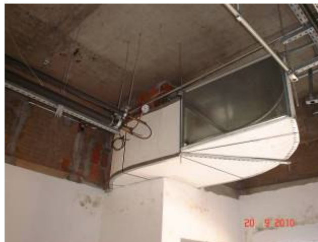
Vista dos dutos de exaustão e insuflamento
