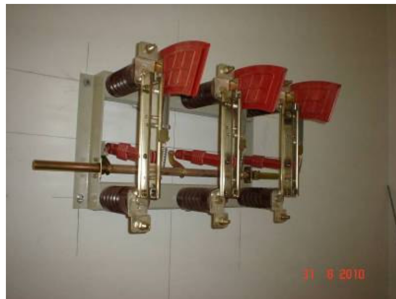
Vista de chave seccionadora da subestação do subsolo
