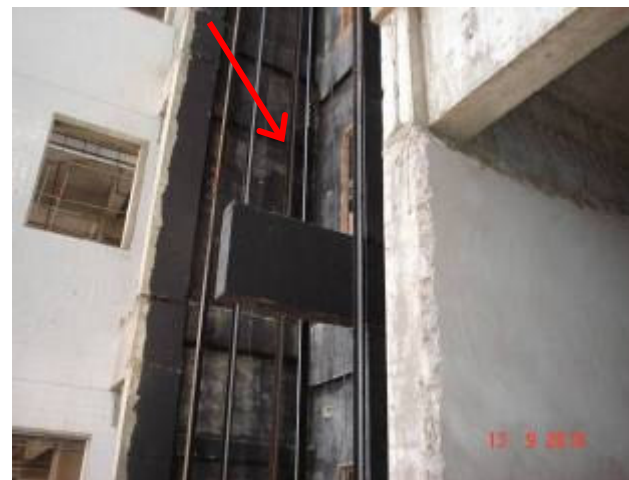
Vista dos cabos e trilhos dos elevadores panorâmicos
