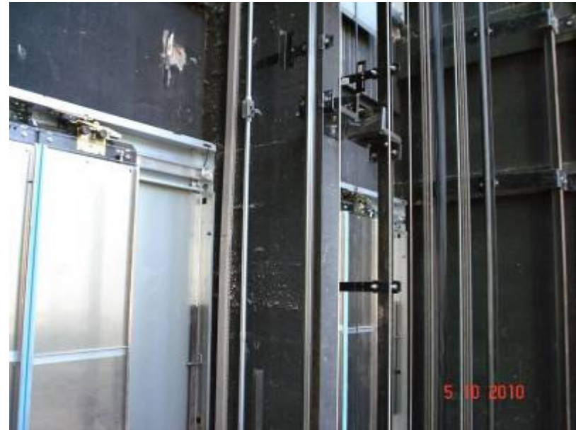
Detalhe dos cabos e peças da instalação de elevadores.
