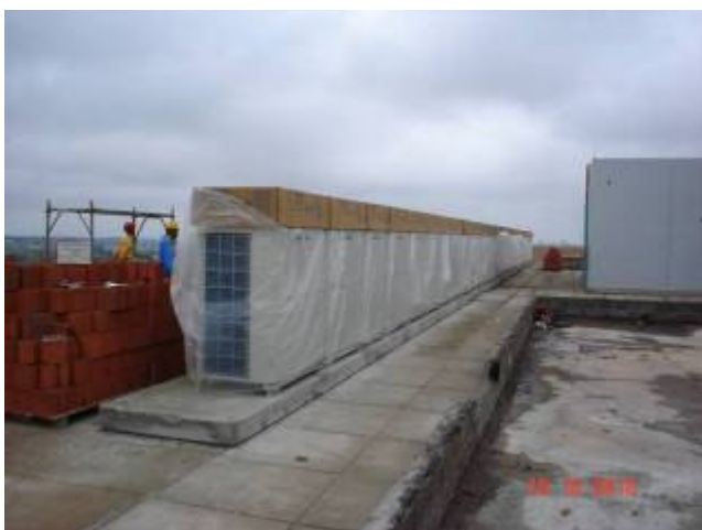
Detalhe das máquinas de ar condicionado (unidades condensadoras) colocadas na cobertura.
