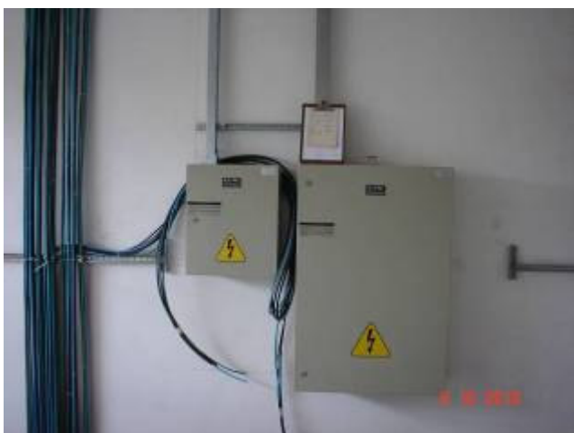
Detalhe da fiação e quadros elétricos no shaft no 2º pavimento.
