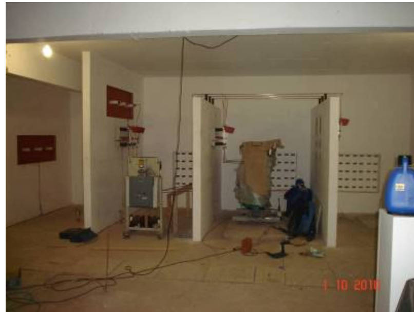
Detalhe de equipamentos instalados na subestação do subsolo.
