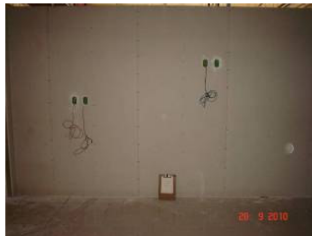
Detalhe das instalações elétricas (fiação) nas divisórias de Dry Wall no 4º pavimento e TV corporativa.
