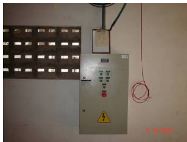
Detalhe do quadro elétrico para bombas de incêndio instalado no 5º pavimento.
