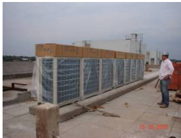
Detalhe das máquinas de ar condicionado (unidades condensadoras) colocadas na cobertura.
