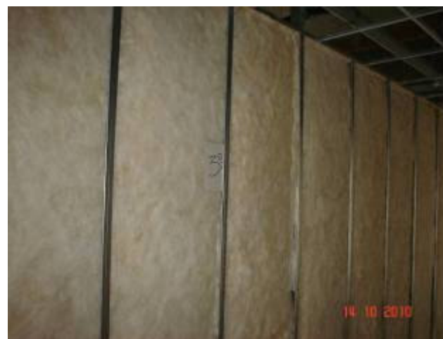
Detalhe do enchimento entre as placas de divisória em Dry Wall com lã de vidro.
