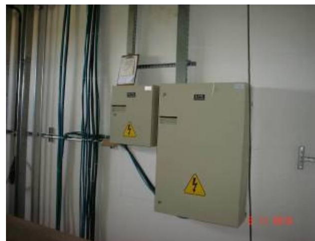
Detalhe das instalações de fios, cabos e quadros de distribuição dentro da sala técnica no 3º pavimento.
