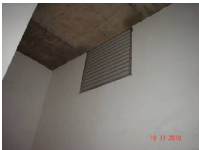
Detalhe de veneziana em alumínio, nos dutos internos de fumaça, das escadas à prova de fumaça.
