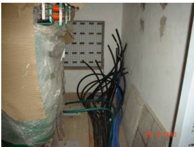
Detalhe das instalações dos cabos de alta tensão e transformador da subestação.
