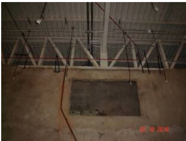
Infraestrutura de instalações elétricas no plenário grande.
