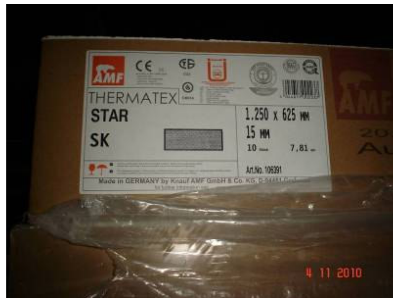
Detalhe do forro mineral depositado no canteiro de obra.
