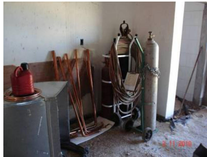
Equipamento de solda, em oxiacetileno, para solda de conexão e tubulação de cobre para tubulação frigorígena de ar condicionado.
