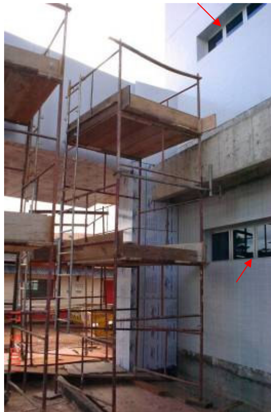
Detalhe de esquadria de alumínio instalada nos pavimentos térreo e 1º.
