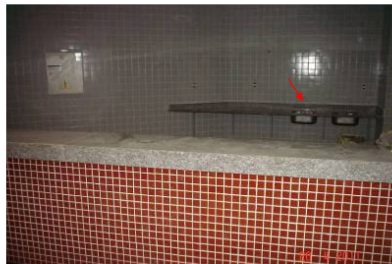
Detalhe de bancada de granito e de cuba em aço inox instalada em copa (cafeteria).
