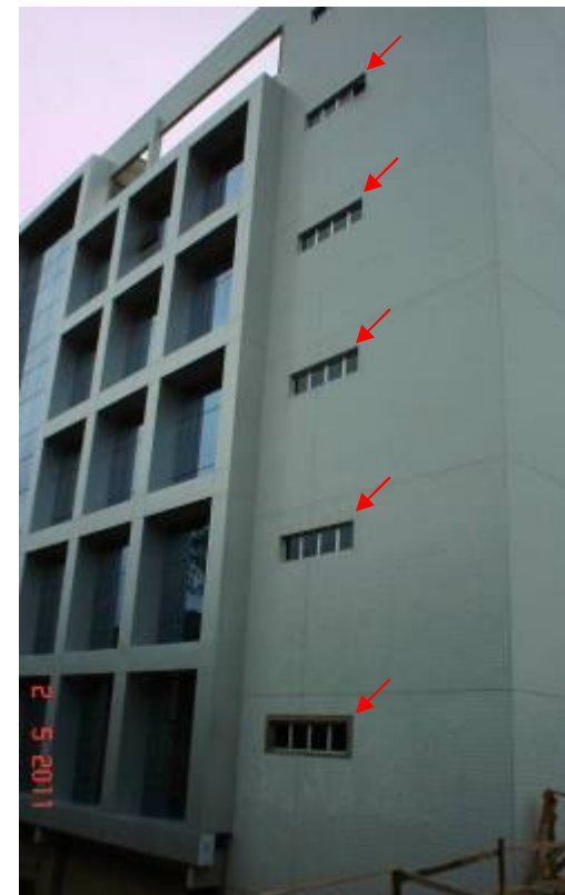
Detalhe de esquadria em alumínio instalada nos pavimentos.
