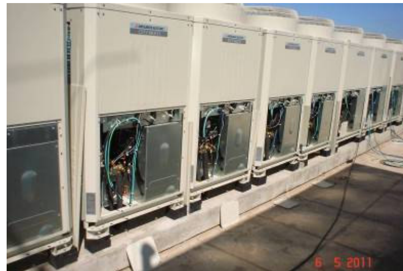
Unidades condensadoras do sistema de ar condicionado na cobertura.
