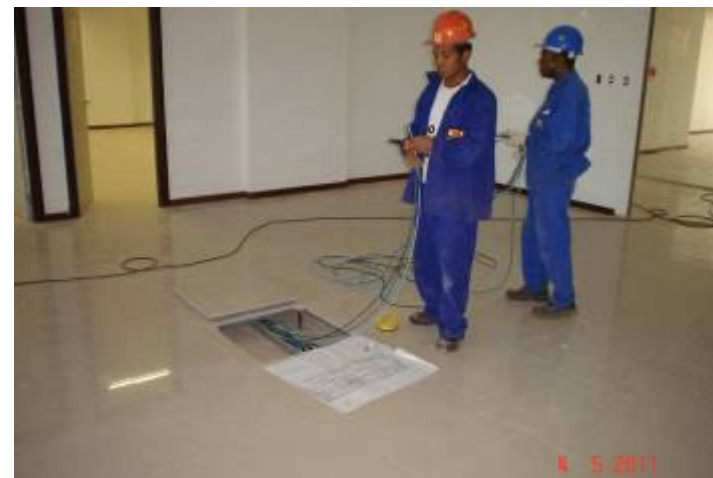
Alimentadores dos QGBT até os pontos dos quadros de distribuição (centrinhos) do piso elevado.
