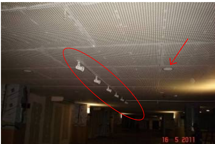
Luminárias instaladas no saguão de entrada (frente aos plenários).
