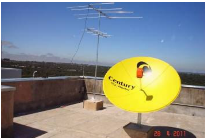
Antena parabólica e antena de TV VHF instalada na cobertura, sobre a casa de máquina dos elevadores panorâmicos.
