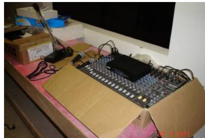
Mixer 16 canais instalado na sala de som dos plenários.
