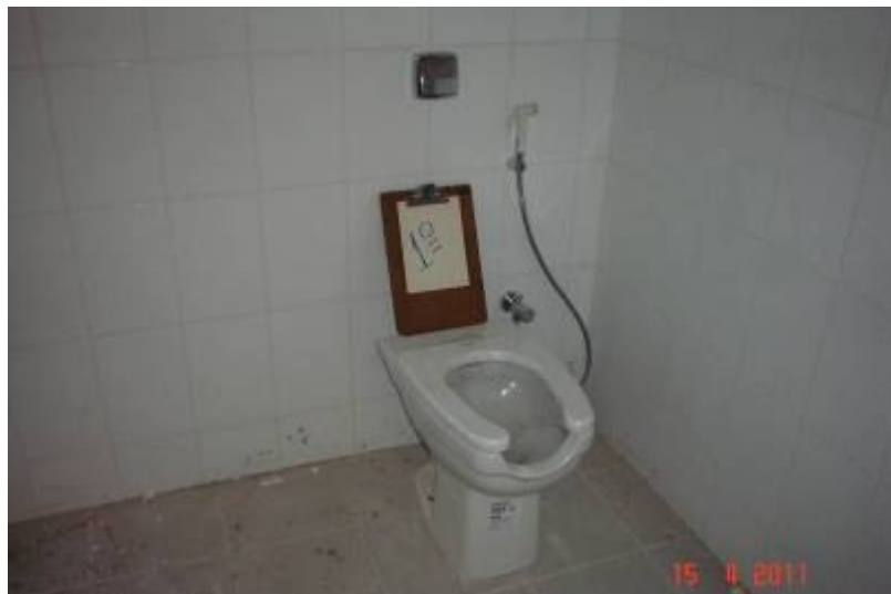
Detalhe de bacia sanitária, torneiras e ducha higiênica instalada em banheiro de portadores de necessidades especiais.
