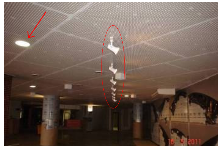
Luminárias instaladas no saguão de entrada (junto à galeria).
