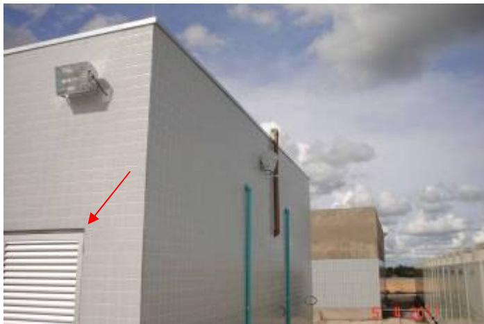
Detalhe de porta em alumínio instalada em casa de máquina na cobertura.
