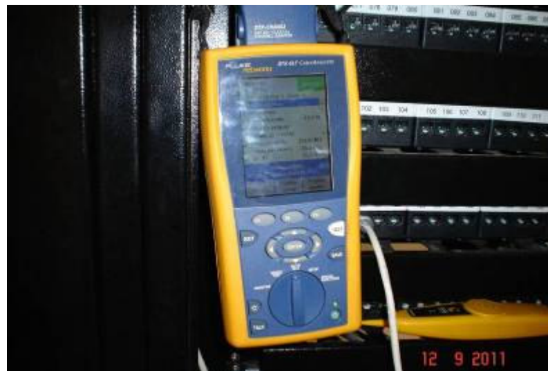
Detalhe do teste de certificação do cabeamento estruturado
