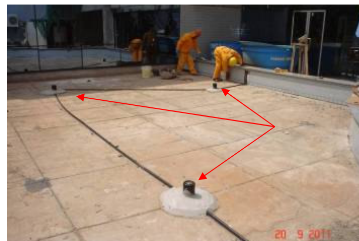
Detalhe de luminária de jardim seco no 1º pavimento.
