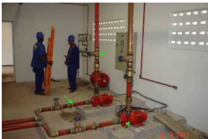
Detalhe dos conjuntos moto bomba, válvulas de retenção e registros para a tubulação de hidrante (5º pavimento).
