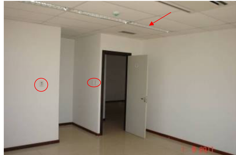
Detalhe das luminárias interruptores e botão de controle de som ambiente no interior das salas.
