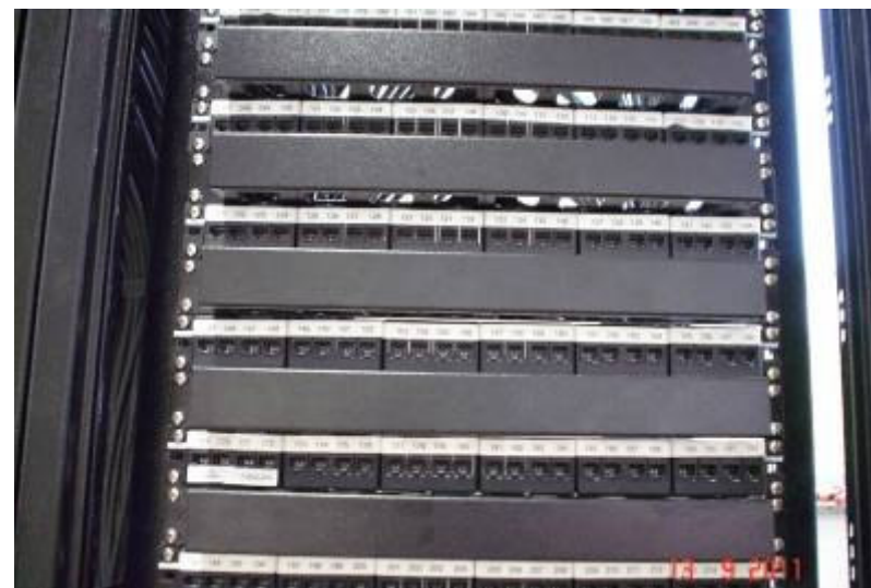
Detalhe da numeração dos pontos de lógica / telefonia nos racks
