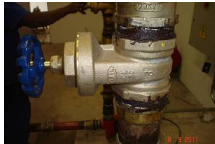
Detalhe de registros instalados em canalização de incêndio juntos as moto bombas (5º pavimento).
