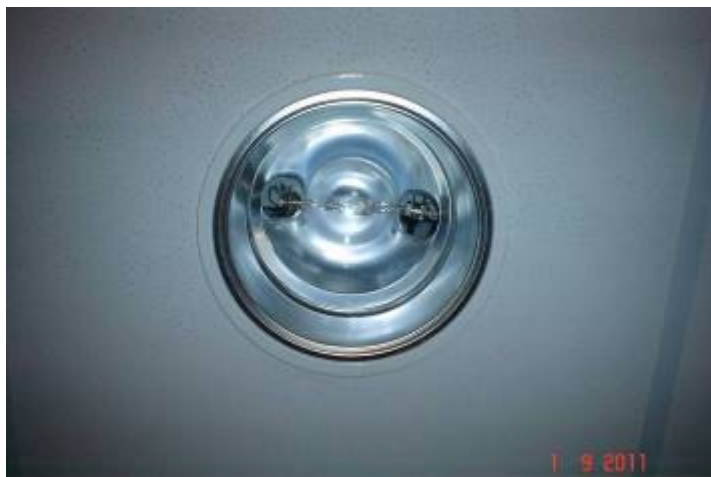
Detalhe da luminária instalada em forro mineral no térreo.
