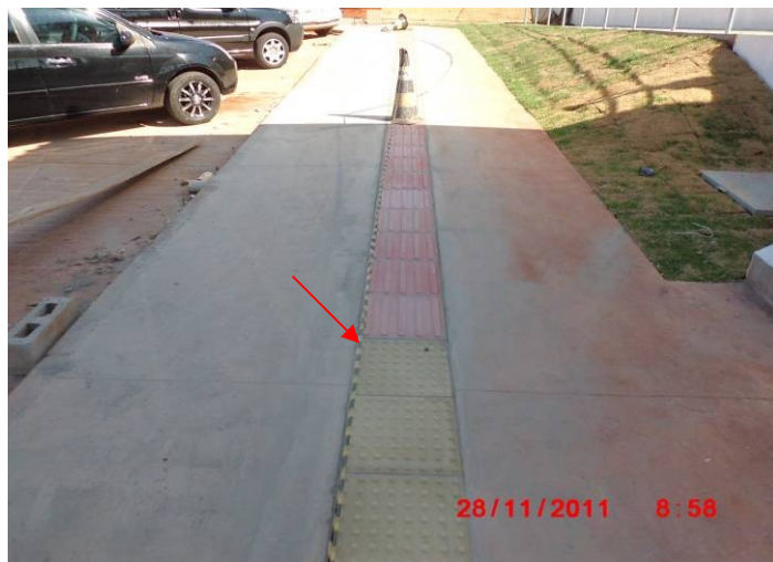
Detalhe do piso tátil / de alerta instalado no passeio público.
