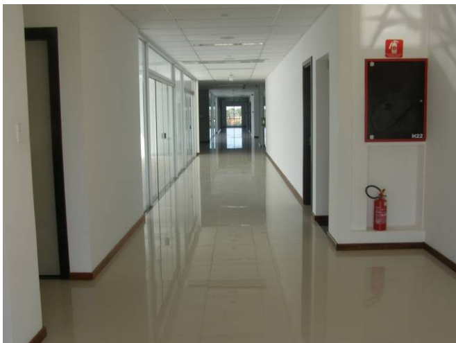
Detalhe da identificação de extintor no 5º pavimento.
