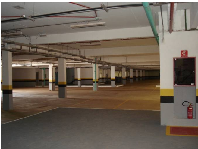
Detalhe de pintura de identificação de extintor no subsolo.
