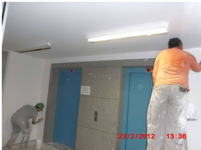
Detalhe de pintura sobre parede no hall dos elevadores do subsolo.
