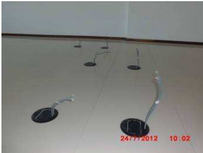
Detalhe dos pontos de lógica e telefonia.
