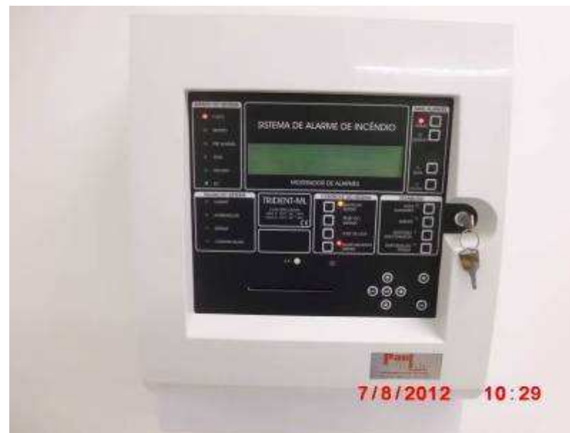
Vista do sistema de detecção de incêndio.
