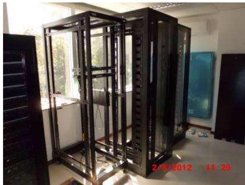
Vista dos racks instalados na sala da informática.
