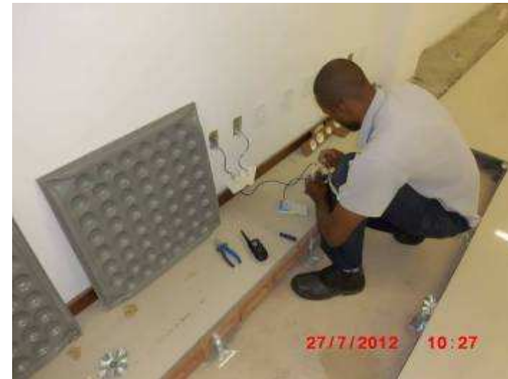
Detalhe dos pontos de lógica e telefonia.
