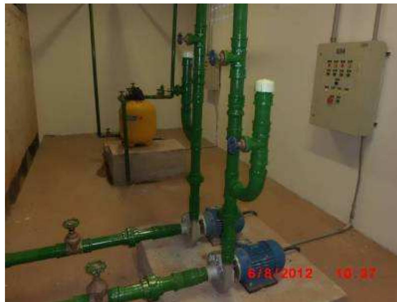
Detalhe das bombas de recalque de água fria.
