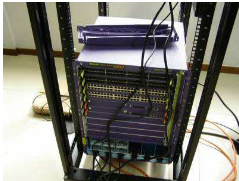
Detalhe dos equipamentos de Tecnologia de Informação (TI).
