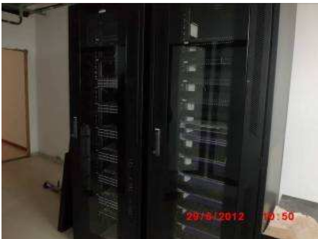
Armários (racks) de equipamentos ativos e patch panels de distribuição do cabeamento estruturado
