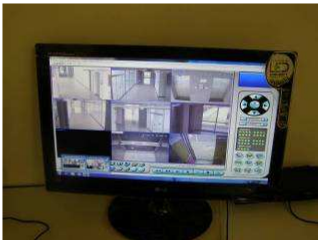
Vista do equipamento de monitoramento de câmeras de CFTV
