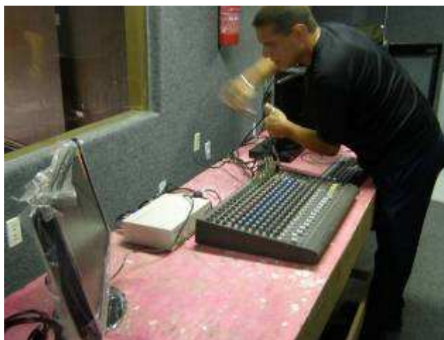
Detalhe da montagem final e treinamento para utilização de equipamentos de sonorização do plenário
