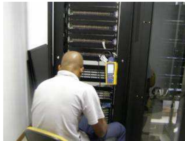
Detalhe da certificação digital do cabeamento estruturado no rack dentro da sala técnica de Tecnologia da Informação
