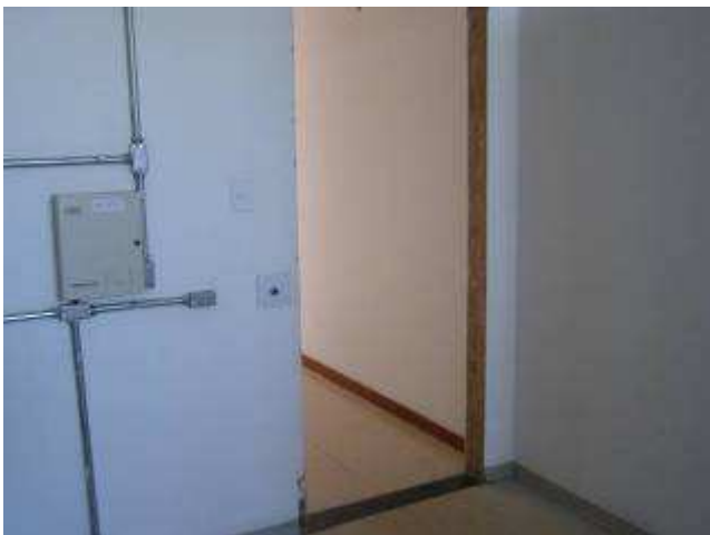
Vista de reposicionamento de porta com controle de acesso
