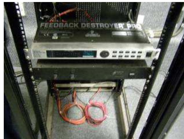
Vista do rack de equipamentos de sonorização do plenário
