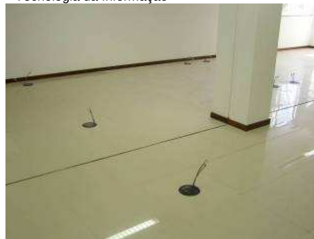
Vista dos pontos de rede, identificados após testes de certificação digital
