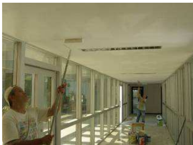
Detalhe de pintura no teto do 5º andar.
