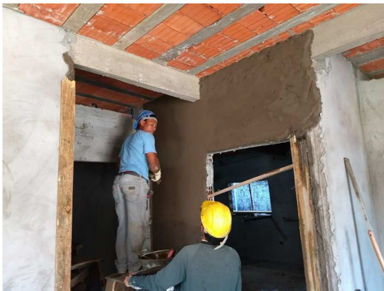
Emboçamento da entrada da sala da OAB
