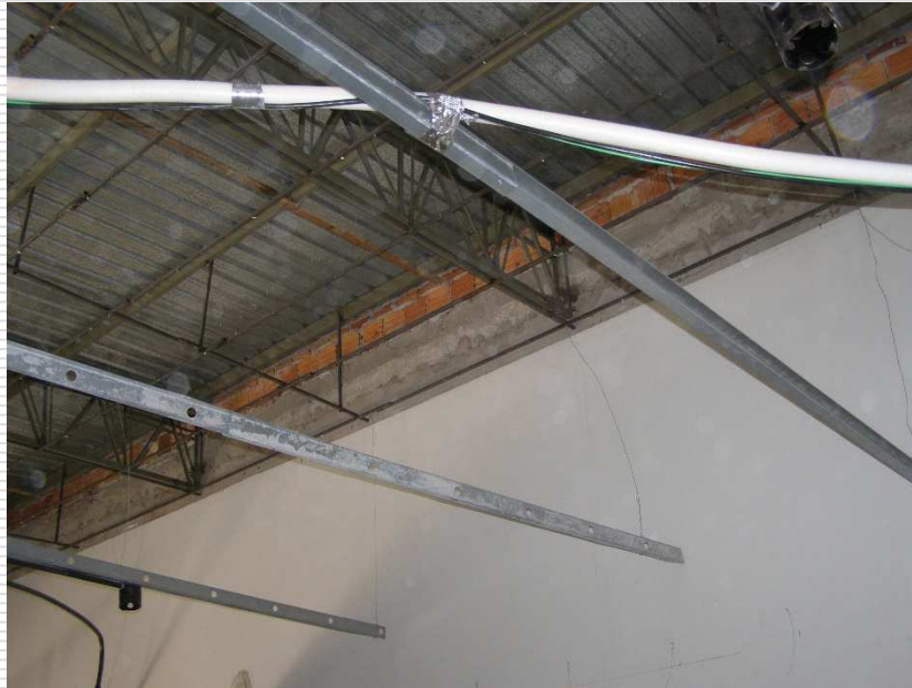
Detalhe do dreno, tubulação frigorígena e da fiação elétrica do ar condicionado
