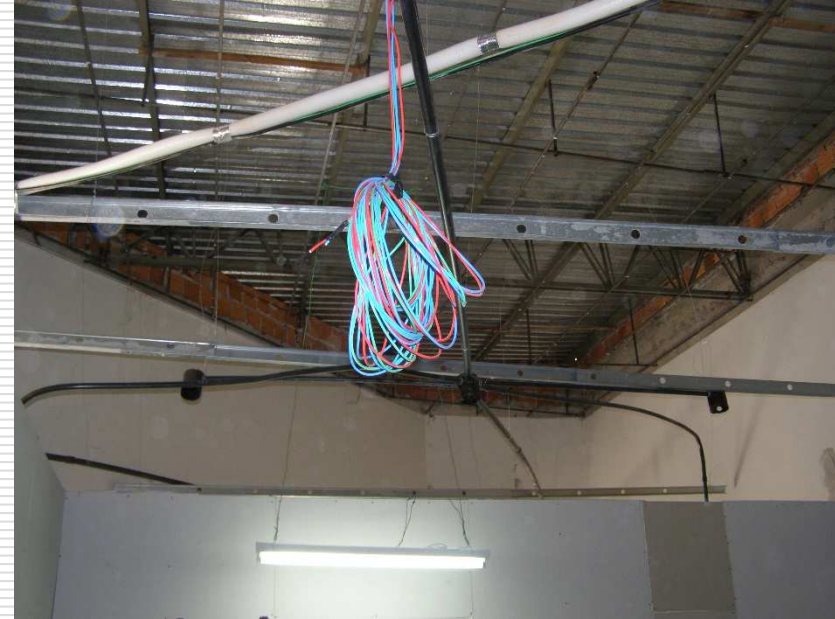
Detalhe da passagem das fiações elétricas das luminárias.
