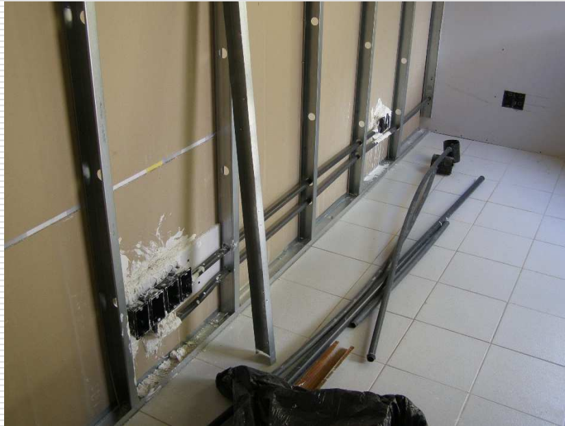
Estrutura de sustentação da parede de gesso acartonado. Verifica-se as tubulações de elétrica e tomadas no seu interior
