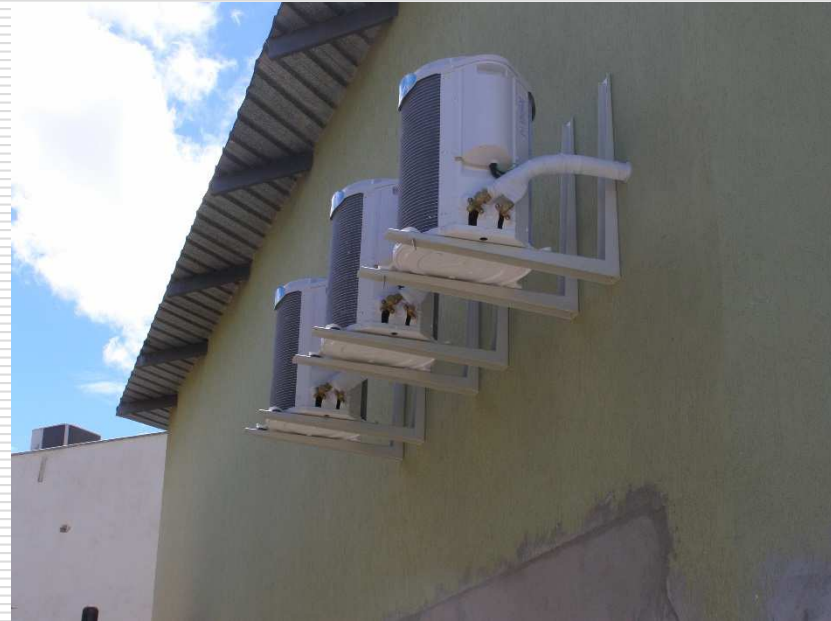
Unidades condensadoras instaladas nas paredes externamente.
