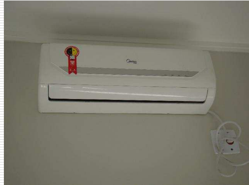
Um dos quatro condicionadores de ar instalados na reforma
