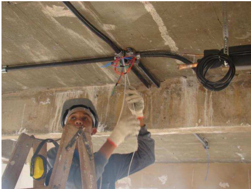
Detalhes da enfição elétrica.
