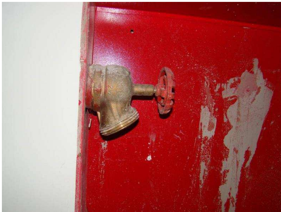
Detalhe das caixas de hidrantes com o registro instalado
