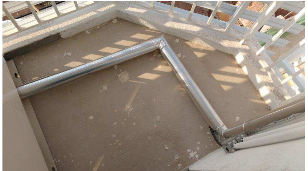
Detalhes das linhas refrigerantes com proteção metálica na sacada técnica.
