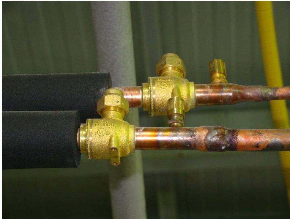
Detalhes dos registros nas linhas refrigerantes.
