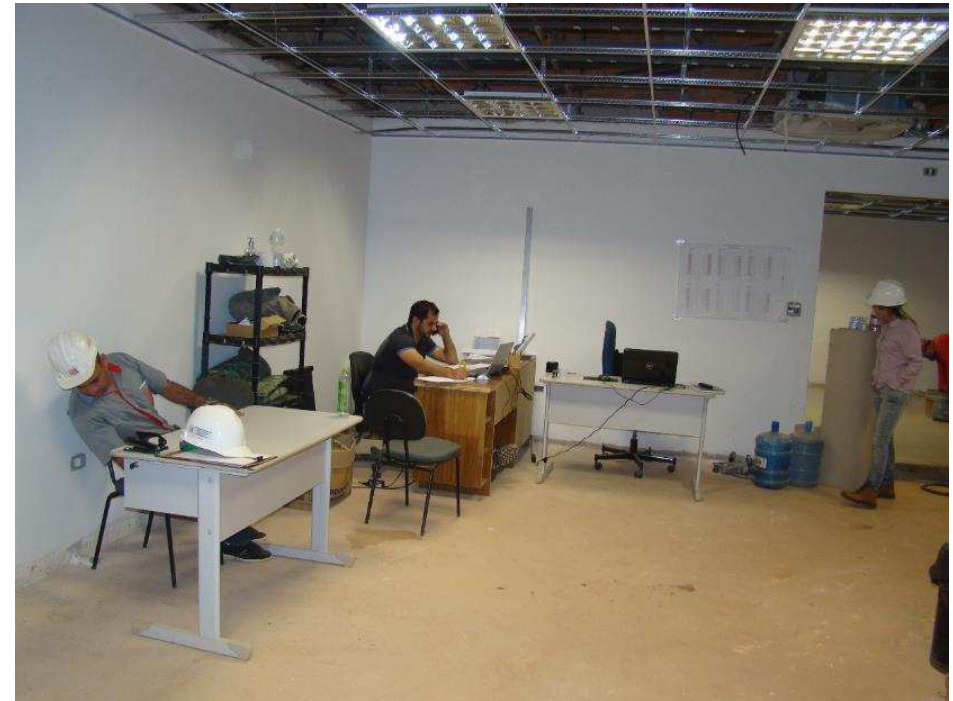
Detalhe das luminárias instaladas e em funcionamento
