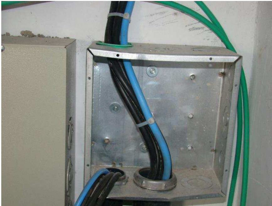
Detalhe da fiação de fases, neutro e terra em caixa de passagem.
