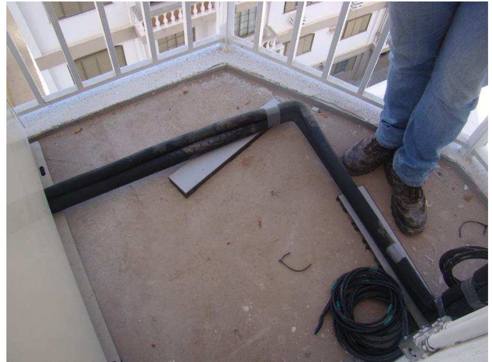
Detalhes das linhas refrigerantes saindo da condensadora instalada na sacada técnica.
