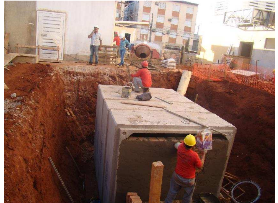
Detalhe da caixa de infiltração de águas pluviais no pátio externo.
