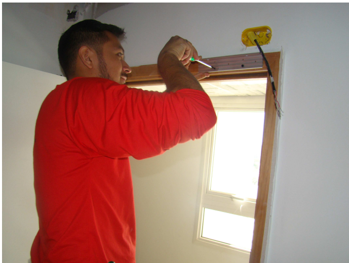
Detalhe da instalação do eletroimã e a central de alarme de incêndio
