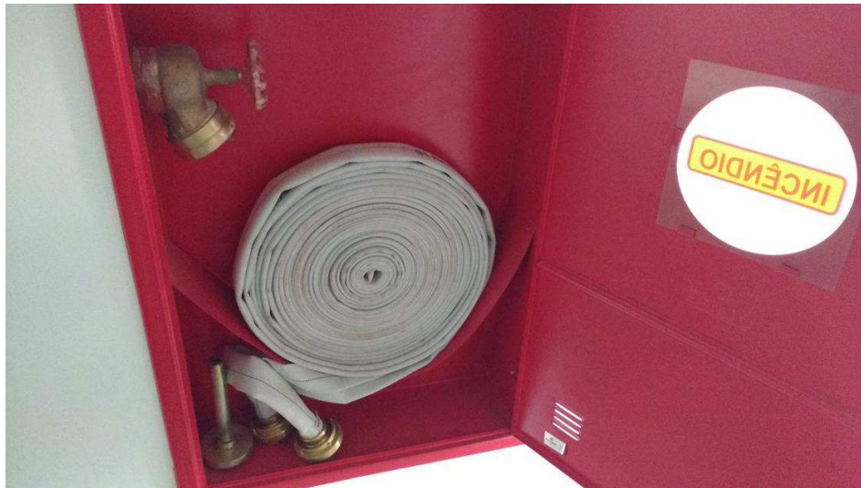
Detalhes do hidrante e dos extintores
