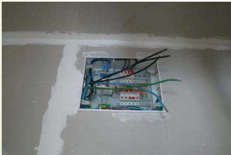
Detalhe do quadro de energia na sala da Secretaria do Foro.
