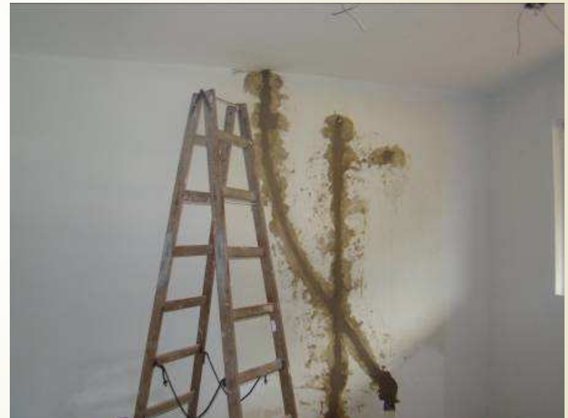
Detalhe da infraestrutura do Split na sala de Audiência
