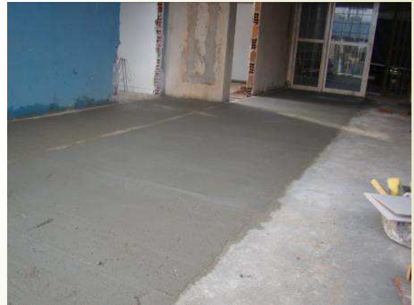
Detalhe do Contrapiso regularizado da sala de espera do Núcleo de Conciliação
