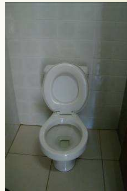
Detalhe do vaso sanitário com caixa de descarga acoplada
