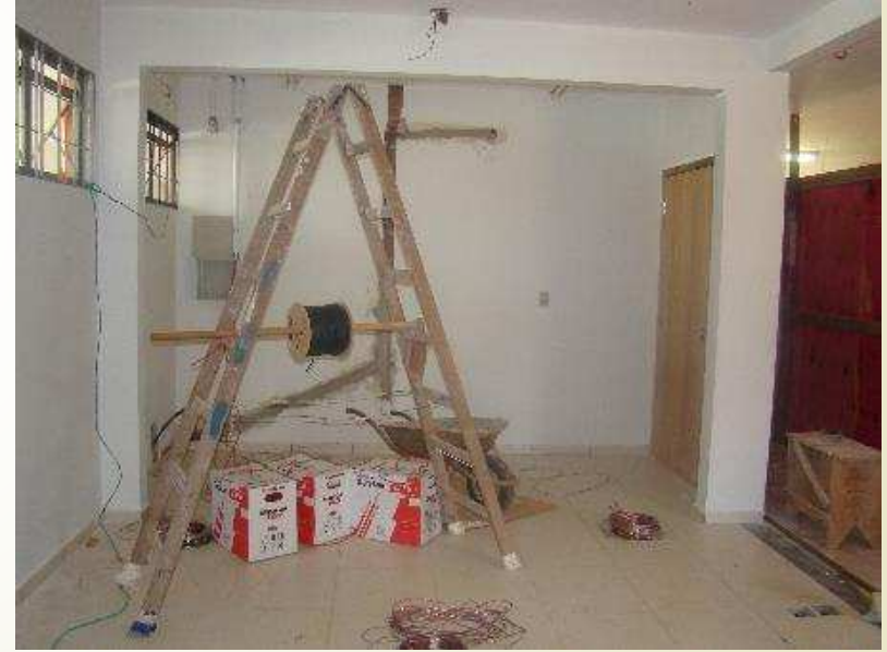
Detalhe da passagem dos cabos de lógica
