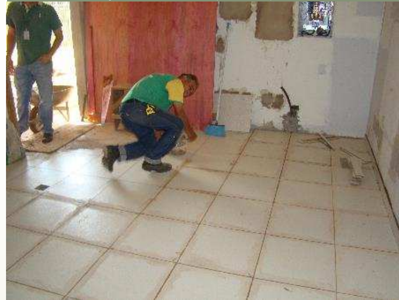
Detalhe do rejuntamento do piso na portaria
