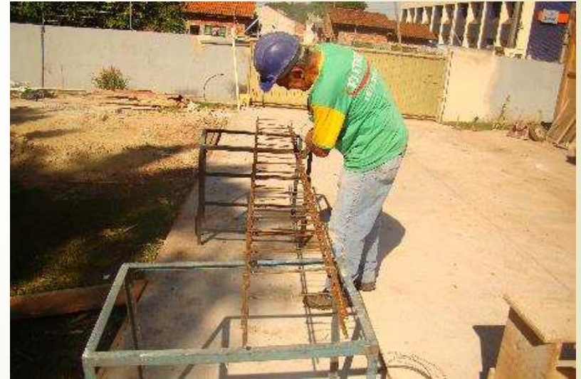
Detalhe da armação da estrutura do pilar da central de atendimento ao cidadão.
