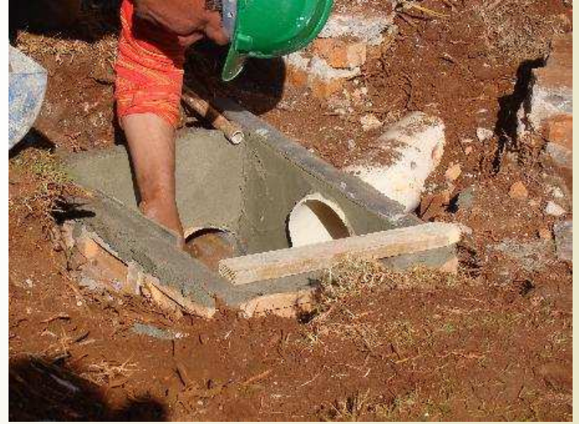
Detalhe da infraestrutura de rede de águas pluviais da Central de Atendimento ao Cidadão.
