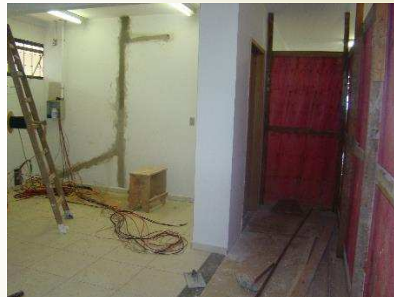
Detalhe da infraestrutura da climatização
