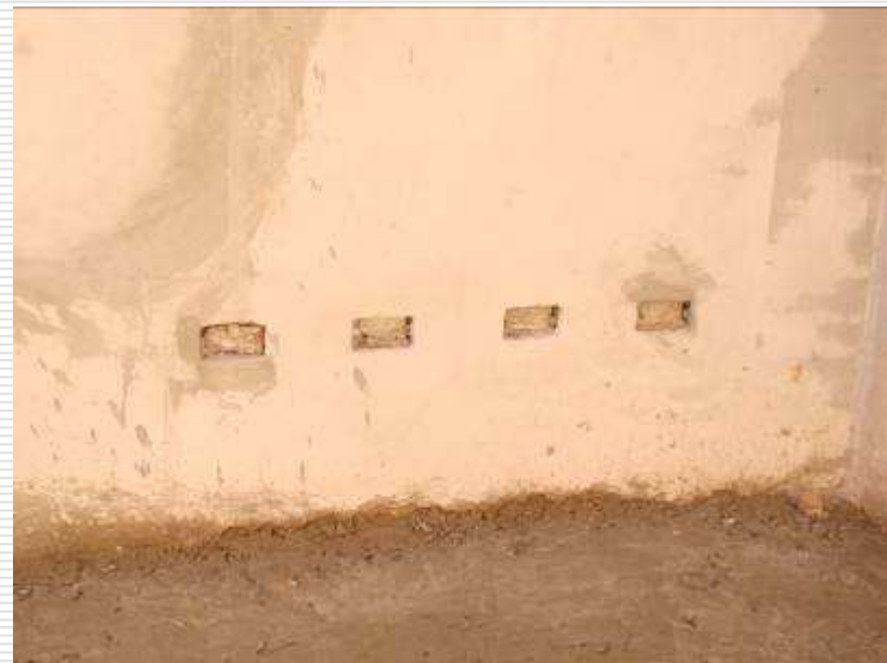
Instalações elétricas - detalhe das caixas para tomadas
