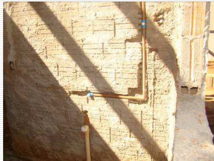
Instalações hidráulicas – tubos e conexões de água fria
