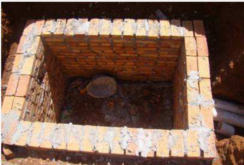
Detalhe do sistema de aproveitamento de água de chuva - " first flush ", com capacidade de 750 litros
