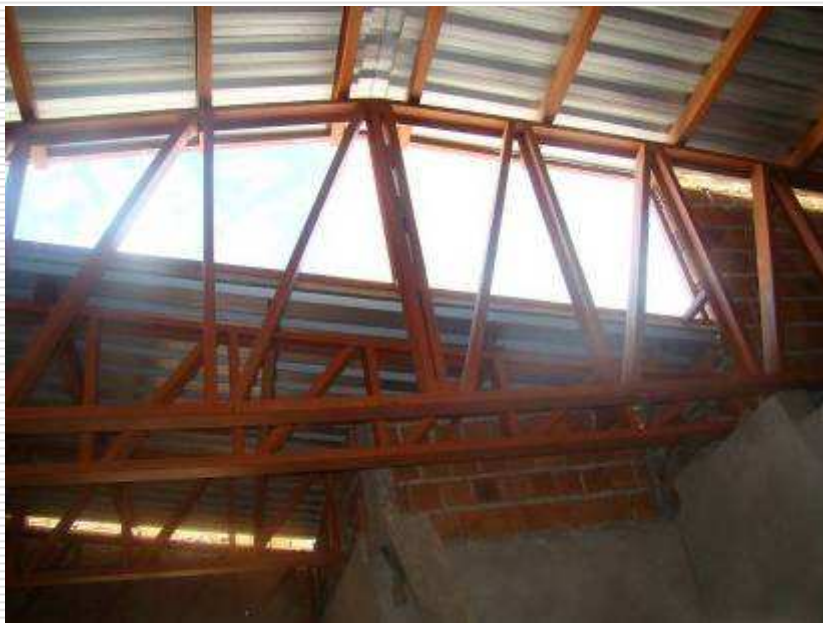
Vão entre tesoura, não previsto em projeto, aguardando autorização para vedação
