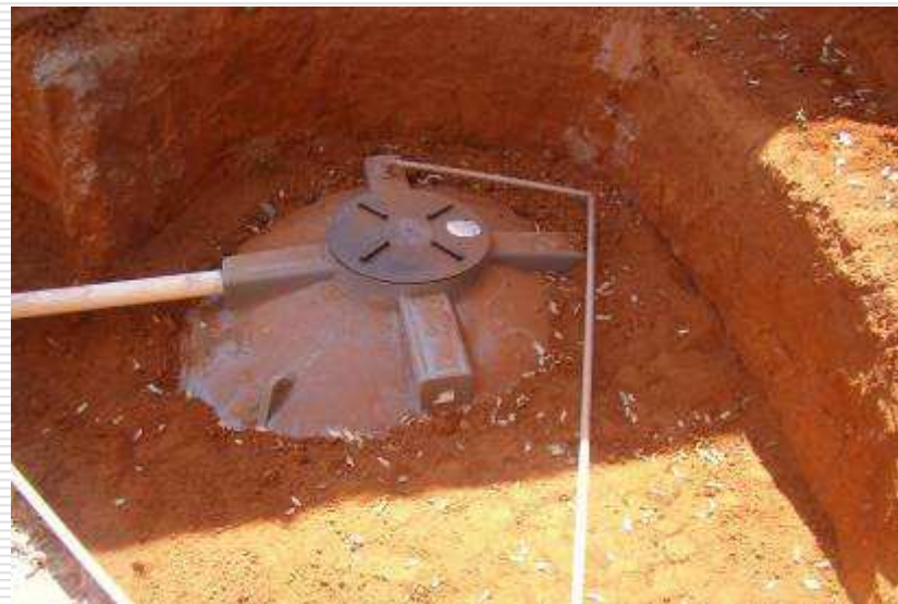
Detalhe das tubulações de alimentação e de recalque das cisternas
