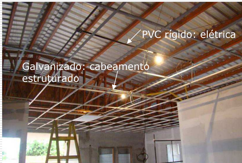
Detalhe do infraestrutura aérea.
