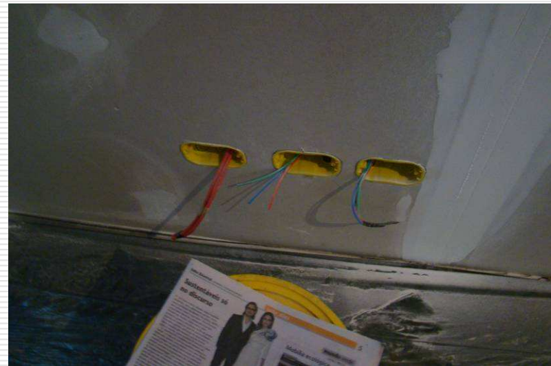
Detalhe das caixas de PVC 4x2 com fiação
