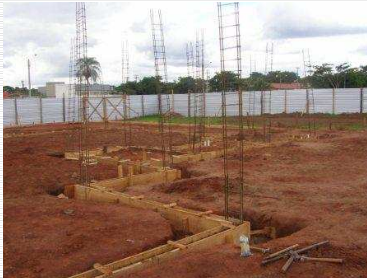
Vista das fôrmas dos baldrames com as ferragens e armaduras dos pilares
