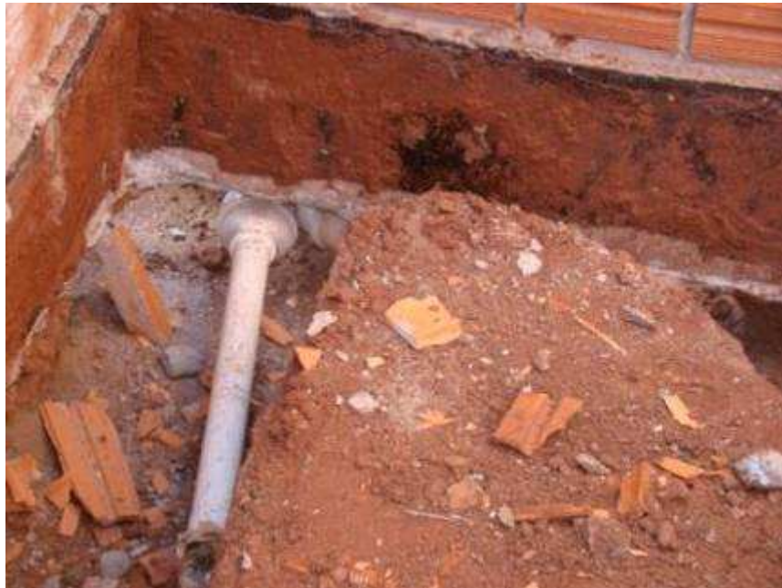
Detalhe das instalações sanitárias
