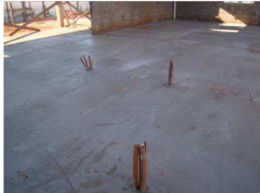
Detalhe da infraestrutura elétrica e de lógica no piso
