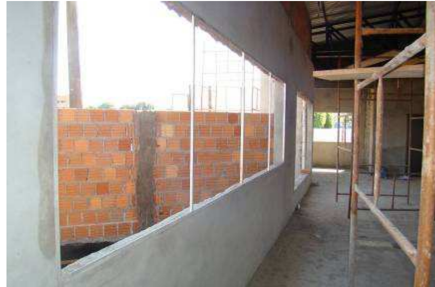
Vista interna dos contramarcos
