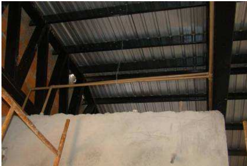
Detalhe da rede de água fria instalada
