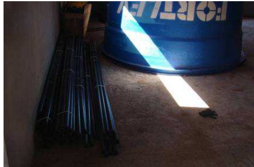
Detalhe do armazenamento das tubulações elétricas e de lógica
