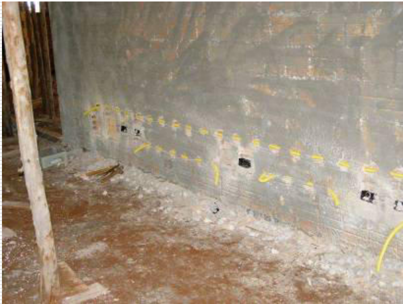
Caixa de tomada de aço galvanizado (4x2)". Detalhe dos conduítes corrugados para passagem dos fios do circuito elétrico
