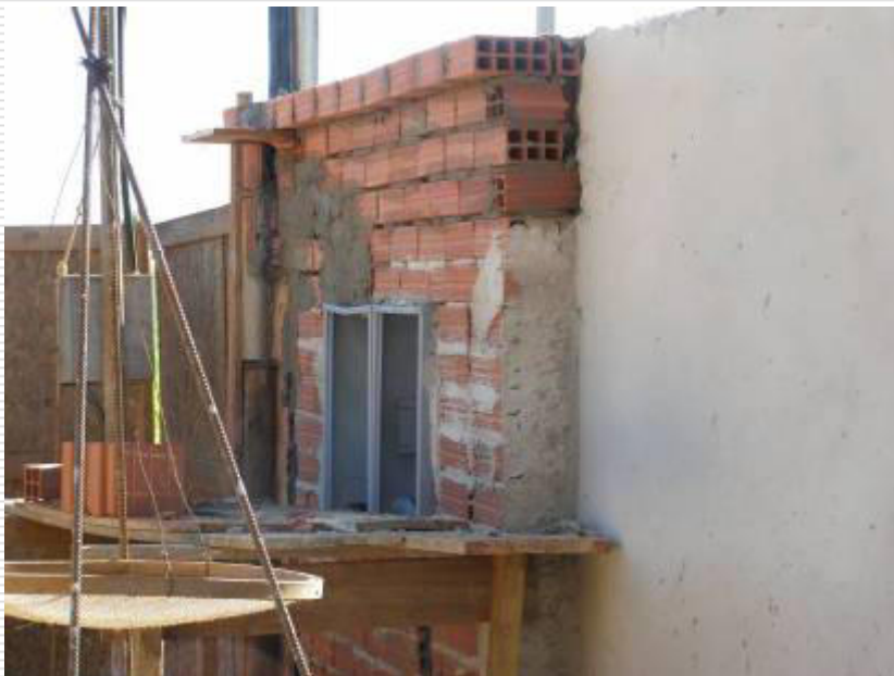
Detalhe do padrão de entrada de energia
