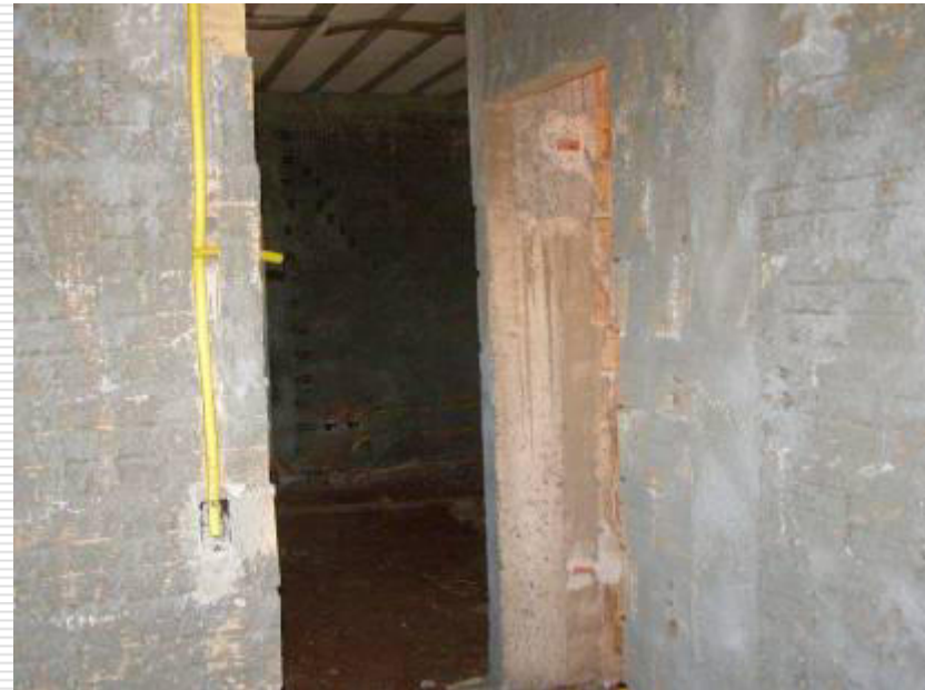
Caixa de interruptor de aço galvanizado (4x2)". Detalhe do conduíte corrugado para passagem dos fios do circuito elétrico
