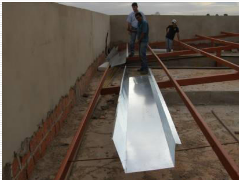
Detalhe da instalação da calha junto à alvenaria e estrutura do telhado
