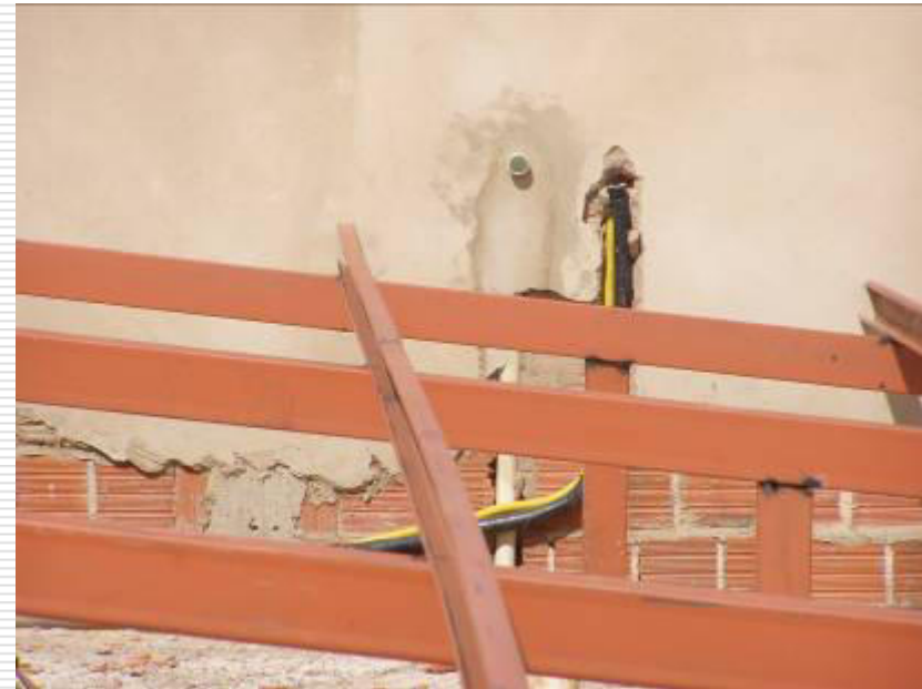
Detalhe tubulação frigorígena e elétrica do ar condicionado (ponto na platibanda onde será instalada a unidade condensadora)
