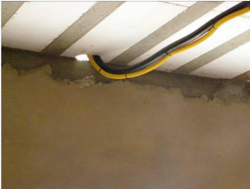
Abertura de passagem na laje para passagem da infraestrutura do ar condicionado
