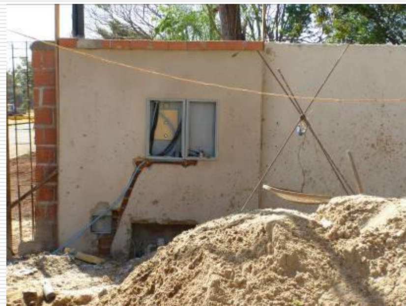
Detalhe do padrão de entrada de energia
