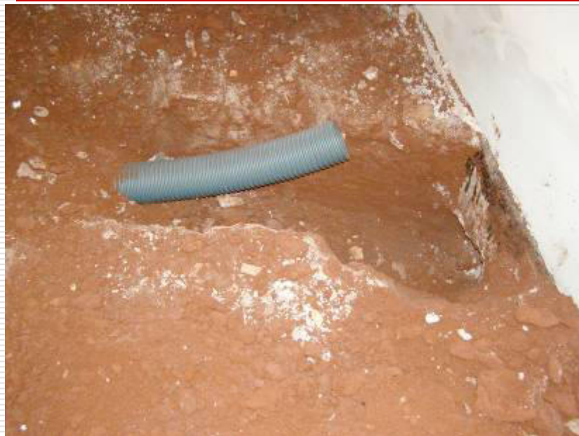
Detalhe da tubulação de 4" para passagem dos cabos elétricos que sai do padrão de energia e segue até o quadro de distribuição da sala técnica
