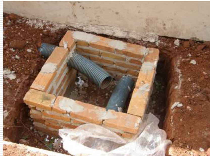
Caixa de passagem para infraestrutura elétrica (sai do padrão de energia e segue até o quadro de distribuição na sala técnica)
