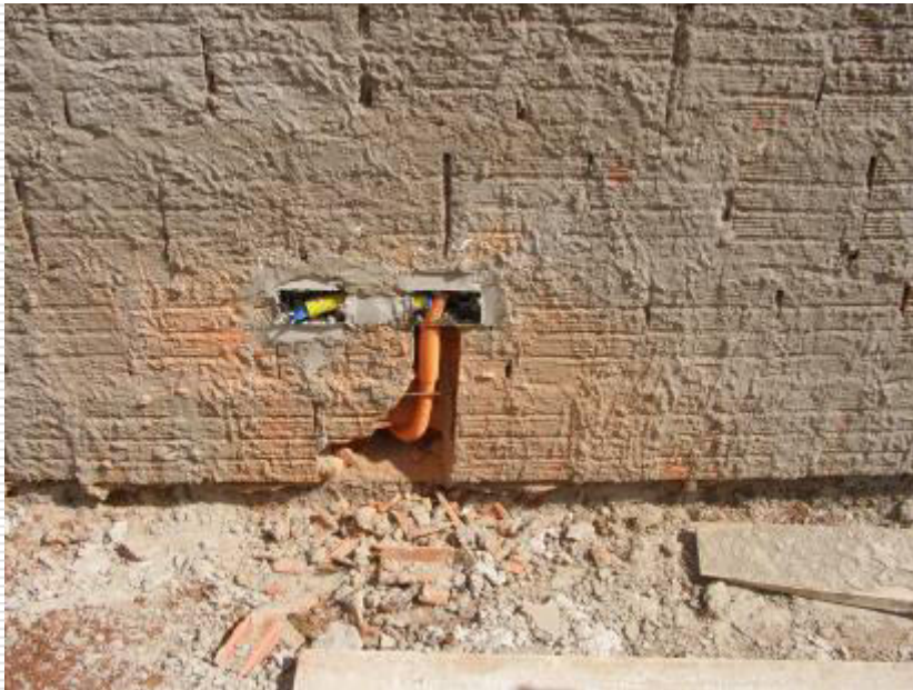
Caixas de tomada de aço galvanizado (4x2)'' instaladas 30 cm do piso no lado externo da construção
