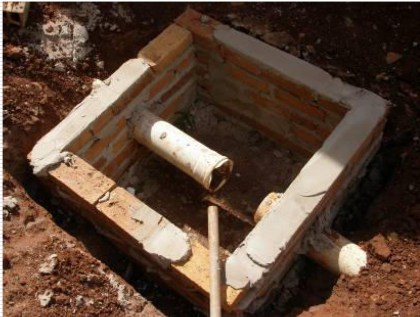
Caixa de passagem de água pluvial (detalhe da tubulação do dreno do ar condicionado)
