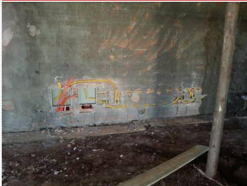
Infraestrutura de instalações elétricas
