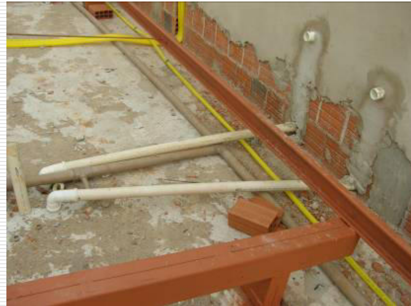
Detalhe sobre a laje das mangueiras para instalação elétrica do ar condicionado e das tubulações hidráulicas dos banheiros
