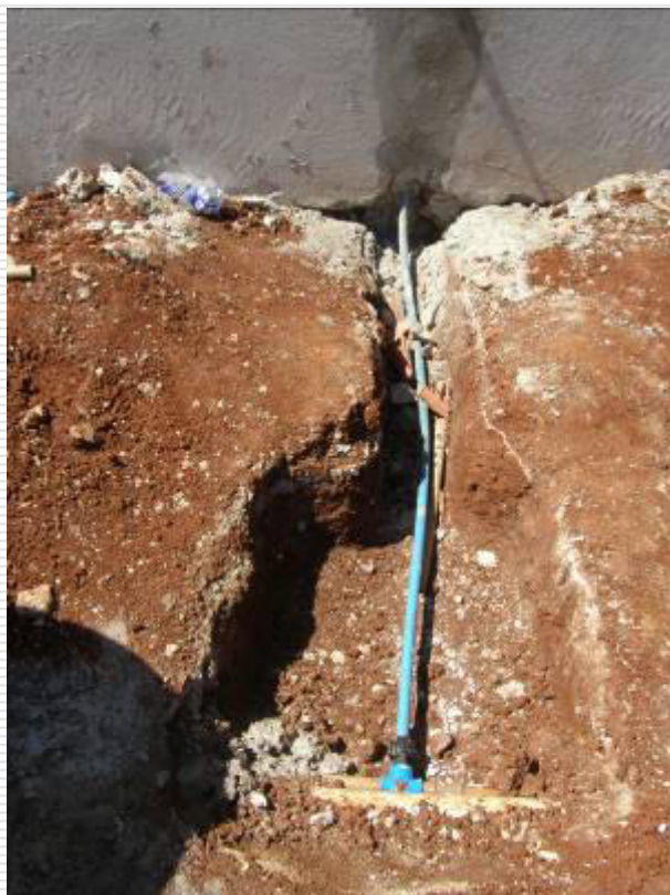
Tubulação de ligação de água fria até a caixa d'água
