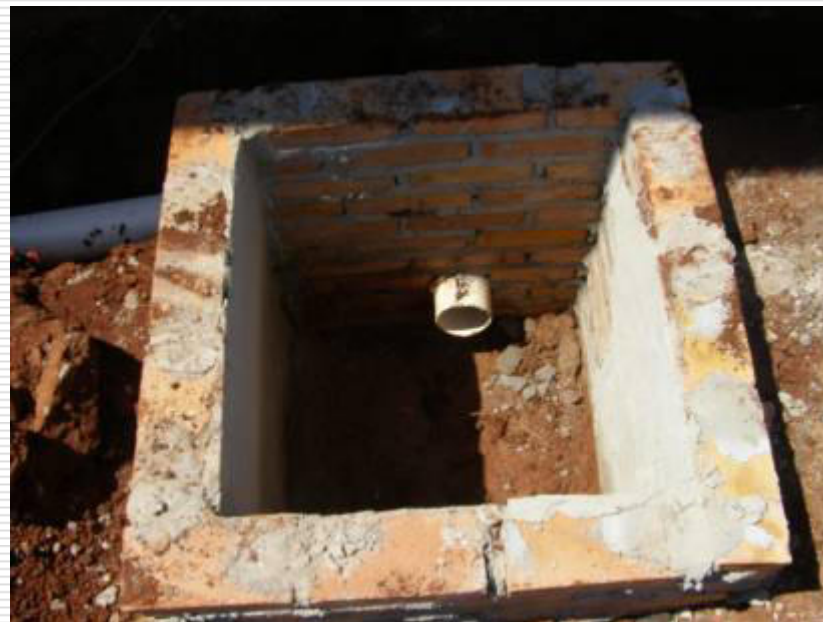
Caixa de passagem para infraestrutura hidráulica (esgoto e água pluvial)
