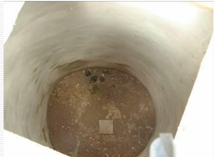
Detalhe do interior da fossa séptica (profundidade 4,0m)
