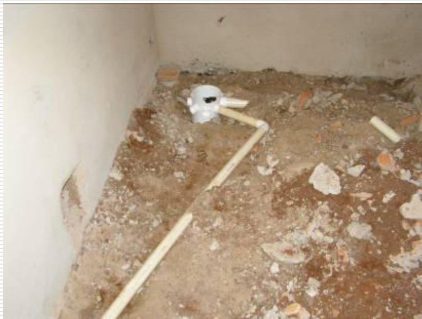
Caixa sifonada instalada no banheiro
