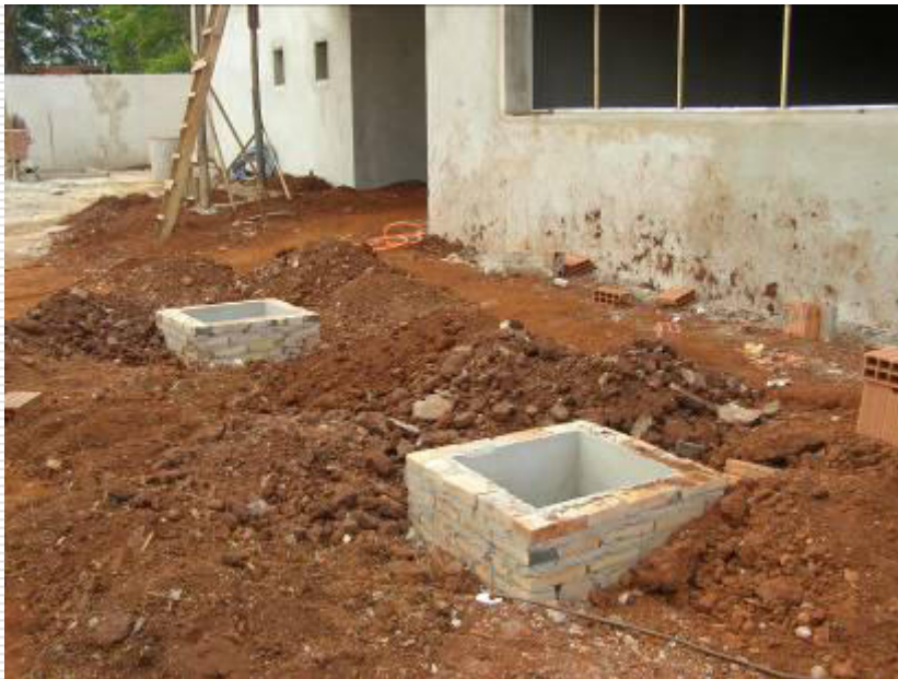
Detalhe do sumidouro à esquerda e fossa séptica à direita
