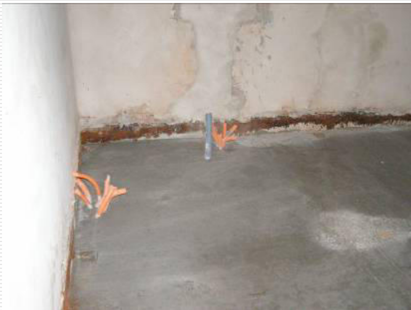
Eletrodutos saindo do piso da sala técnica
