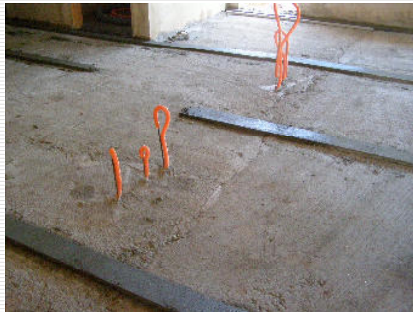
Eletrodutos saindo do piso da secretaria (ligação de tomadas)
