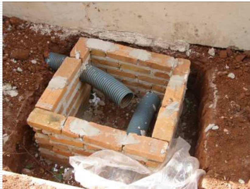
Caixa de passagem instalação elétrica
