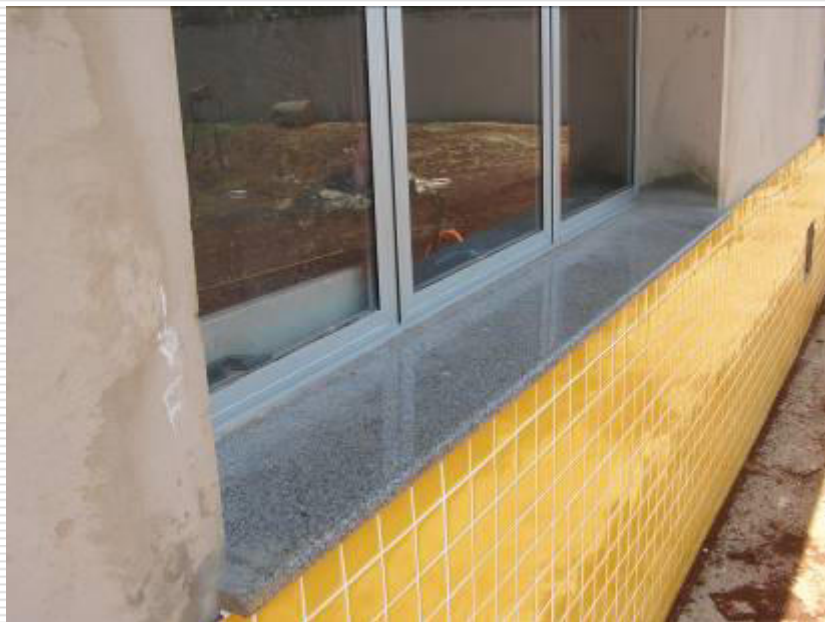
Detalhes das esquadrias metálicas (porta e janela). Nota-se o peitoril em granito assentado sob a janela.
