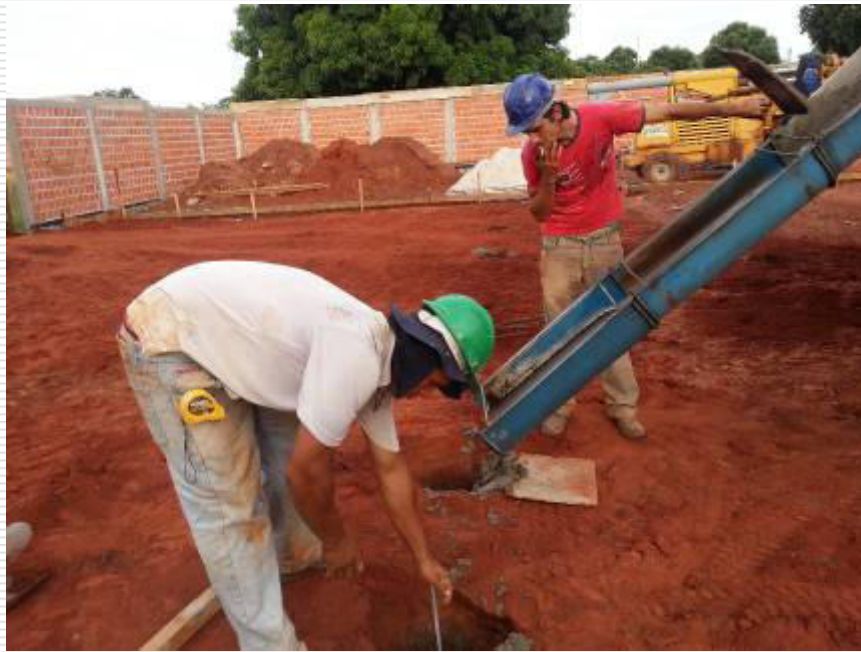
Enchimento das estacas escavadas com concreto de fck 25 MPa dosado em central
