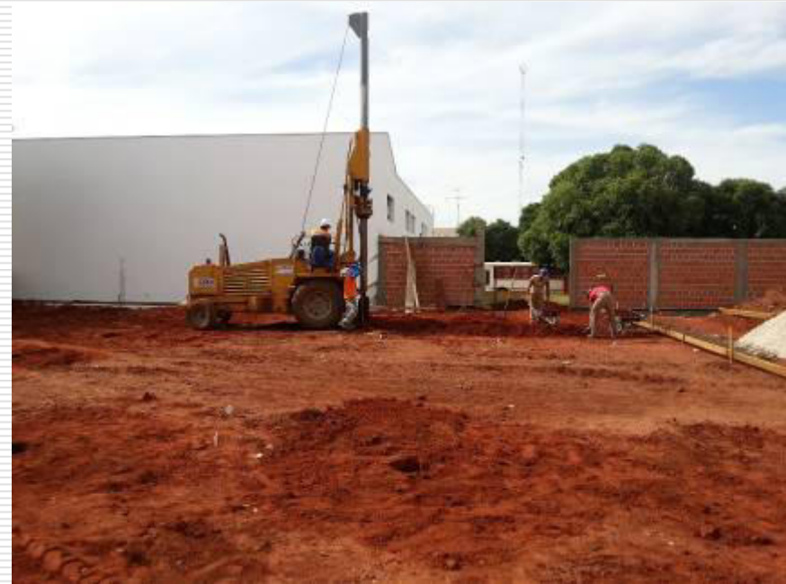
Detalhe da perfuratriz hidráulica fazendo a escavação das estacas de 30cm de diâmetro
