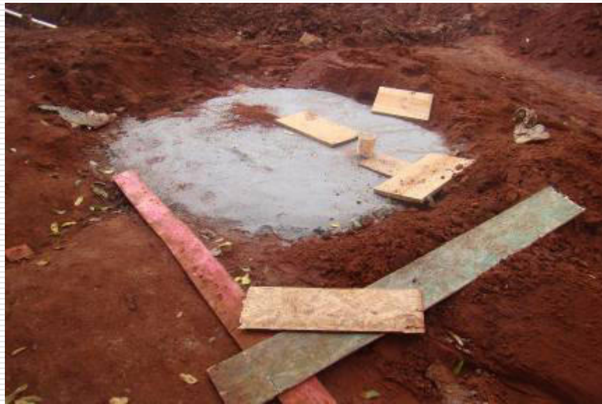
Detalhe da fossa séptica (instalação provisória esgoto)
