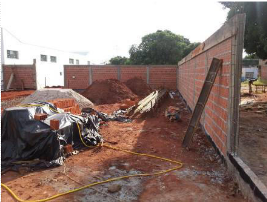
Construção do muro de alvenaria para fechamento lateral da face sul e leste do terreno
