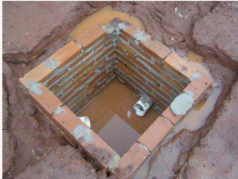
Infraestrutura do esgoto, caixa de passagem dos banheiros.
