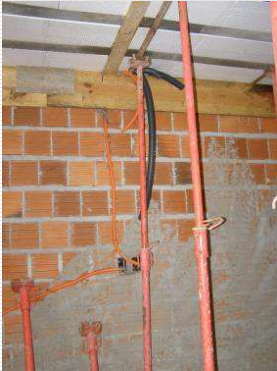
Infraestrutura para alarme, CFTV e som
