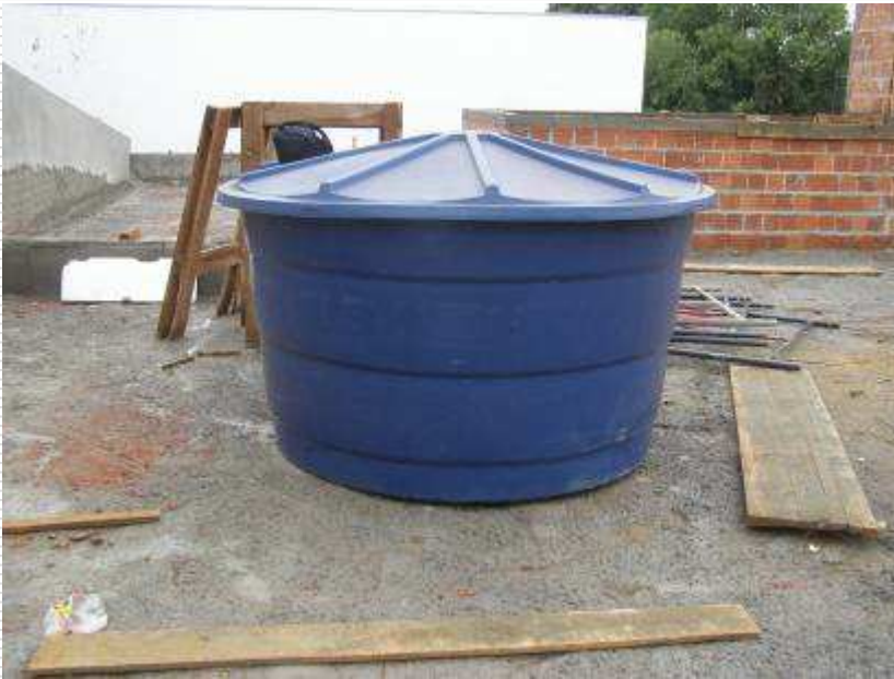
Caixa d'água com capacidade em volume de 3.000 litros
