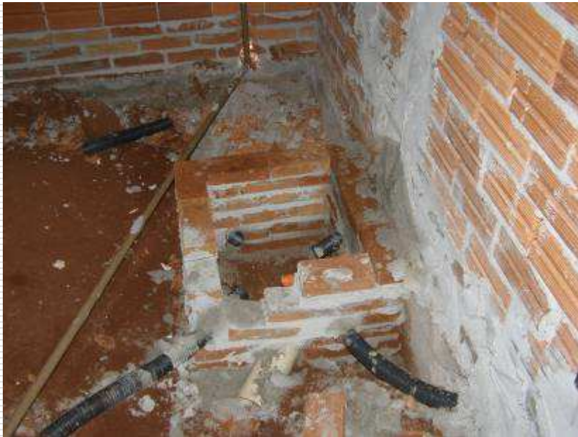
Detalhe da infraestrutura do cabeamento estruturado
