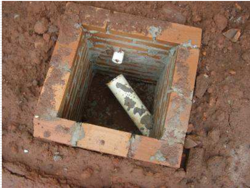
Infraestrutura do esgoto: caixa de gordura da cozinha
