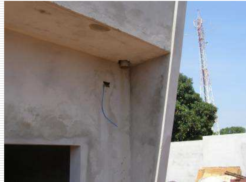
Detalhe da infraestrutura para alarme/CFTV com o ponto de instalação de câmera de segurança com cabos de lógica CAT6
