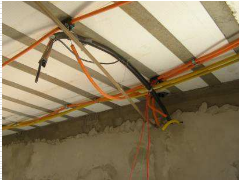
Detalhe da infraestrutura para ar condicionado; tubulação frigorígena e dreno
